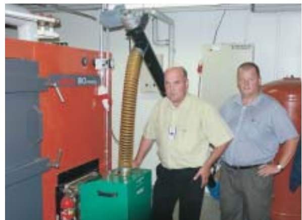
Pelletti on tasalaatuinen puupolttoaine, jolla on suuri energiasisältö. Pellettipoltin ja kattila soveltuu pienen julkisen kiinteistön lämmitykseen (Vapo Oy).
