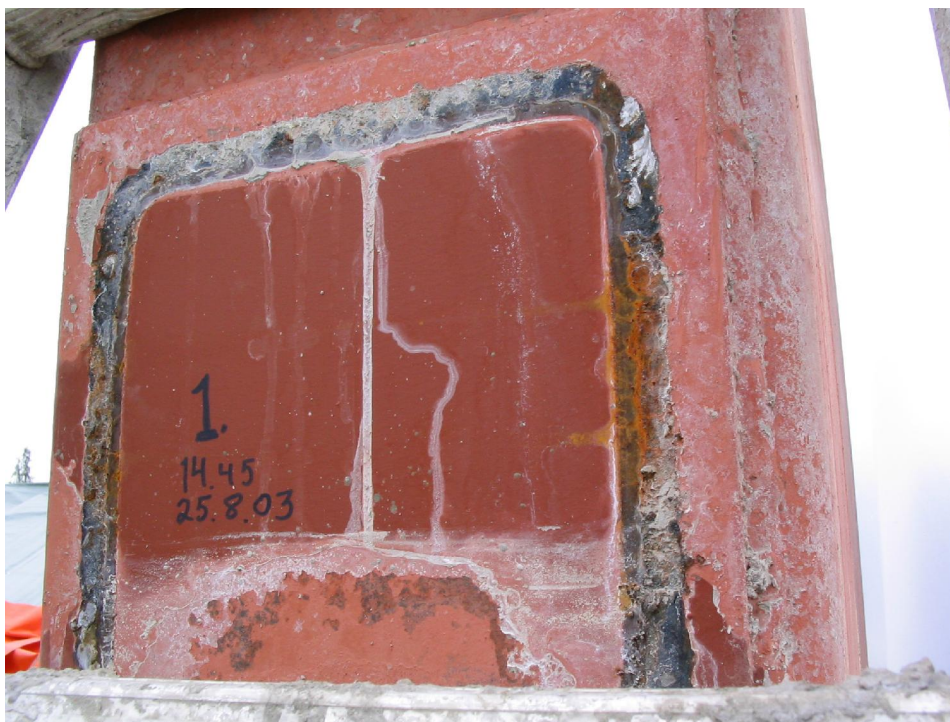
Kuva 16. Konsolin hitsin riittämätön kiinnitys ja tunkeuma putkipilarin ulkopintaan.
