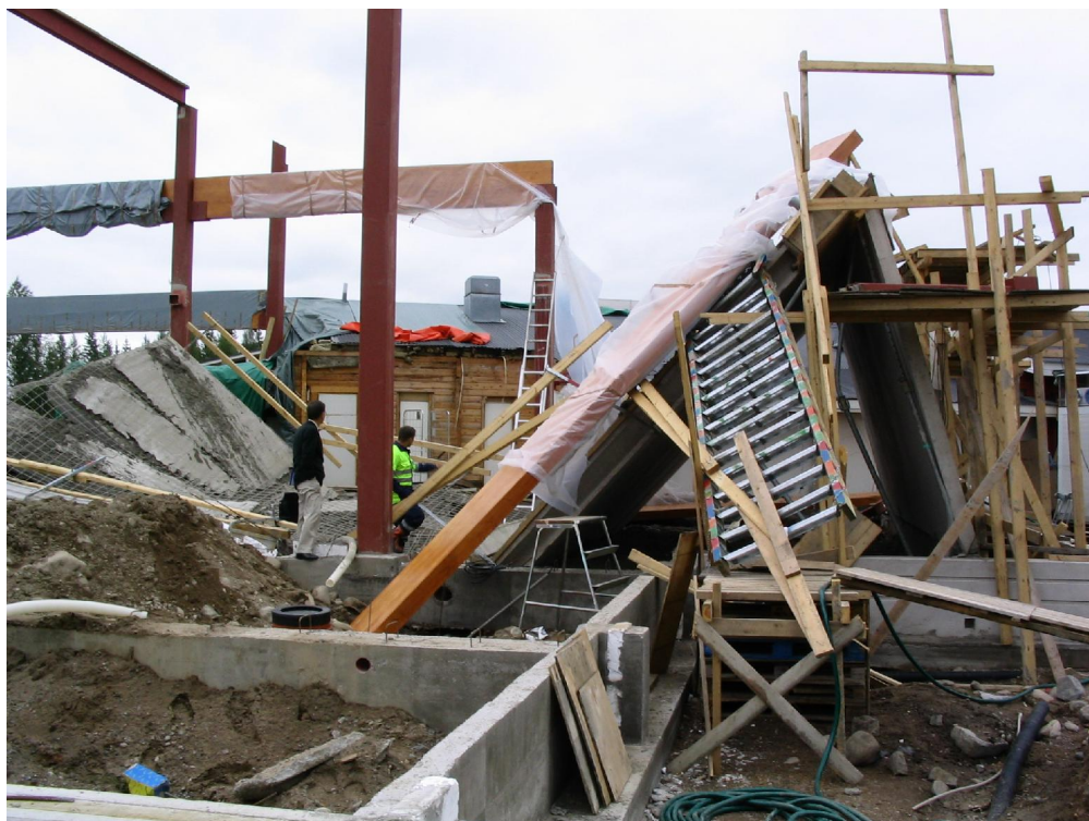
Kuva 14. Ontelolaattavälipohjan sortuma v. 2003.
