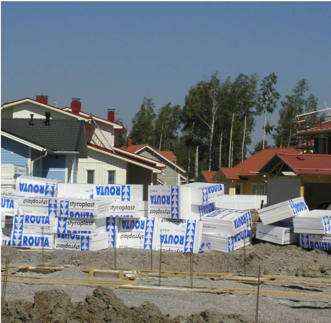
Kuva 5. Pientalojen aluerakentamisessa erityishaasteena on työmaa-alueen käytön suunnittelu toimivaksi, kun vapaata tilaa on vähän.
