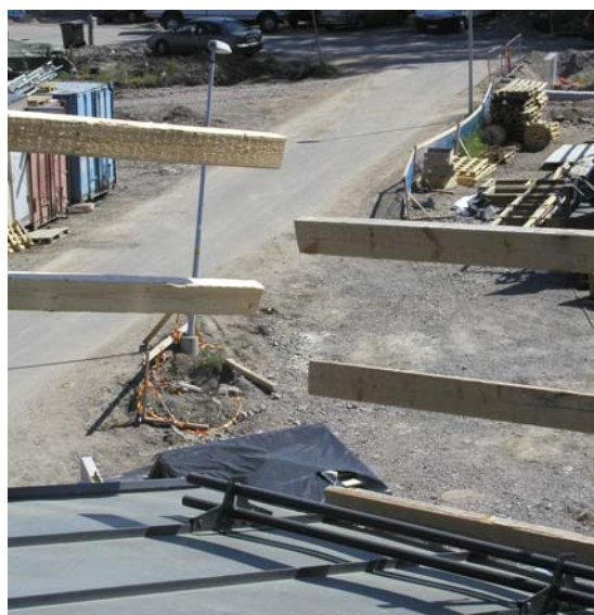
Kuva 12. Kattokaiteiden nurkkaliitos on jäänyt keskeneräiseksi.
