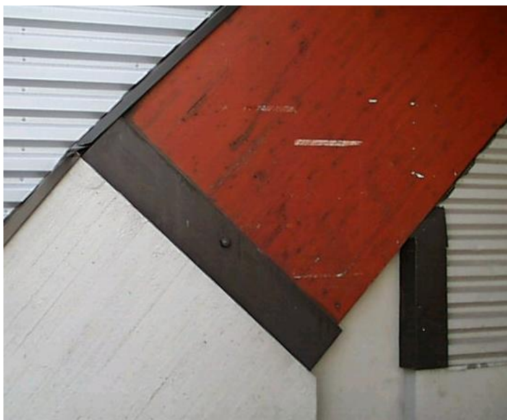
Kuva 2.2 Ongelmallinen perustusliitosdetalji: ulostuleva kaarenpää on teräskengässä ja liimapuu on sivuiltaan verhoilematon.
