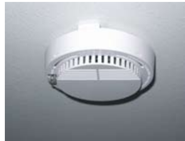
Häkä- ja palovaroitin asennetaan kattoon. Kuvat: Kidde Finland Oy ja SPEK.
