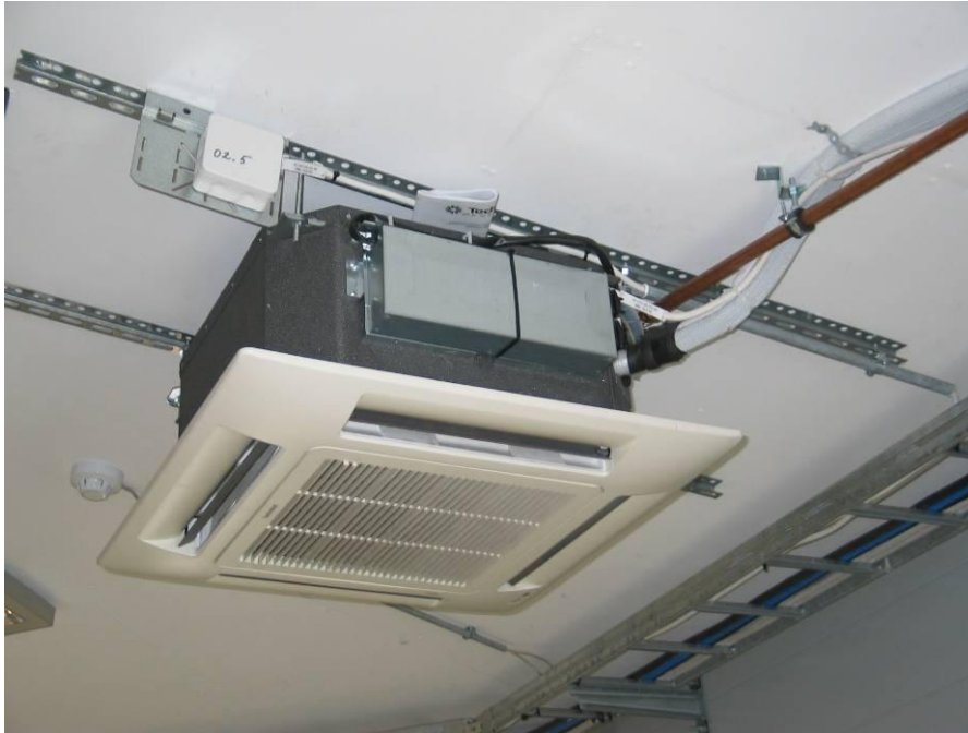
Kuva 12. Mittaussuojarakennuksen ilman jäähdytyslaite
