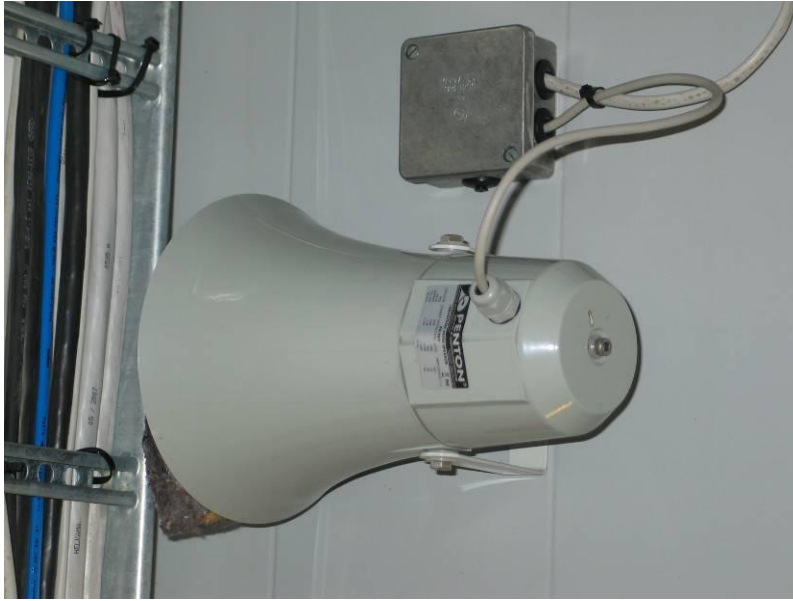
Kuva 16. Mittaussuojarakenuksen hälytin toteutettu kovaäänisellä
