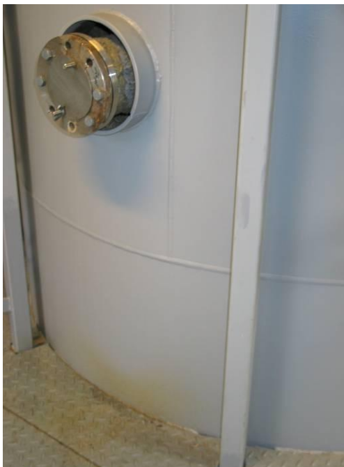
Kuva 15. Piipun ja lattian välinen suljettu rako
