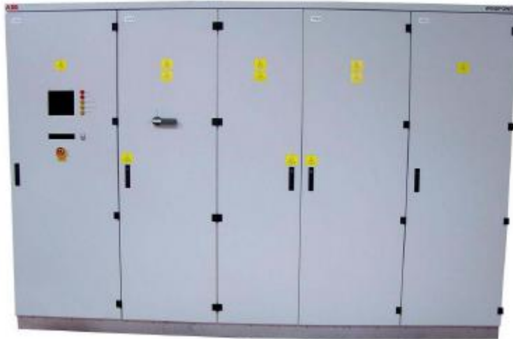
Kuva 31. ABB:n 2 MW:n taajuusmuuttajayksikkö [8].
