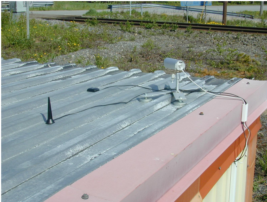
Kuva 2. Kamera magneettikiinnityksellä ja GSM/GPS-laitteen antennit laitehuoneen katolla.
