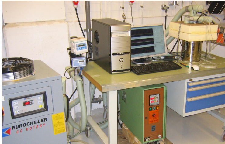
Kuva 4.5.6. Lämpöakun tietokoneohjattu mittauslaitteisto.
