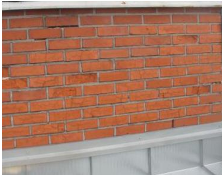
Kuva 9. Pakkasvaurion rapauttamaa julkisivupintaa.
