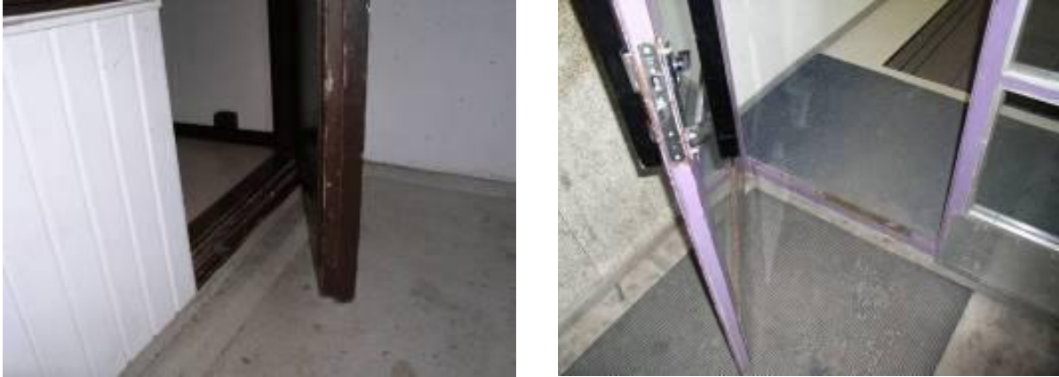
Kuva 22. Puinen parvekeovi ja porrashuoneen metallinen ulko-ovi. (Kuvat Antti Nikkanen 2009)
