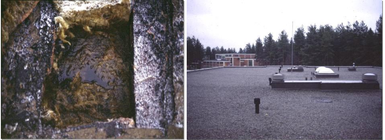
Kuva 28. Katon puutteellinen kaltevuus, katemateriaalien laatu, liikuntasaumojen toteutus, puutteelliset detaljiratkaisut ja kattoon kohdistuvat rasitukset olivat keskeisiä syitä loivien kattojen suureen kosteusvaurioiden määrään.
