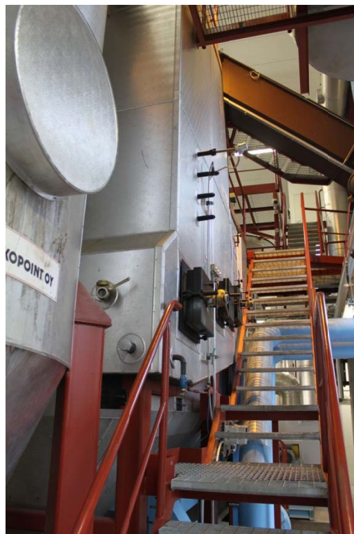
Kuva 12. Tyypillinen viistoarinakattila, jonka pääpolttoaineena käytetään palaturvetta (kuva E. Alakoski).
