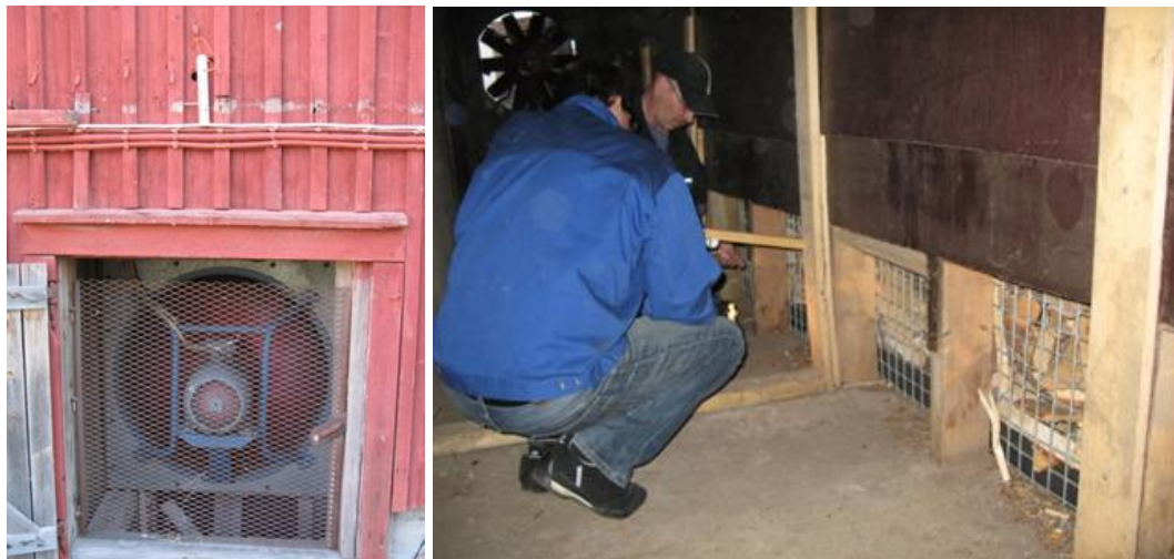
Kuva 14. Kylmäilmakuivurin puhallin ja puhalluskanava.
