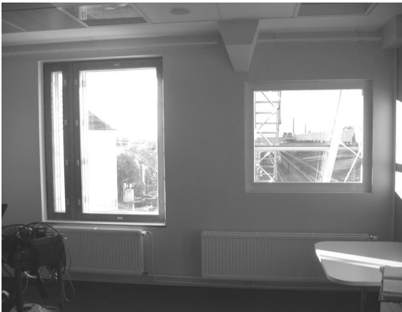
Kuva 2. Nykyisissä eristystiloissa olevia ikkunoita. Avattavat tuuletusikkunat eivät sovellu eristystiloihin.
