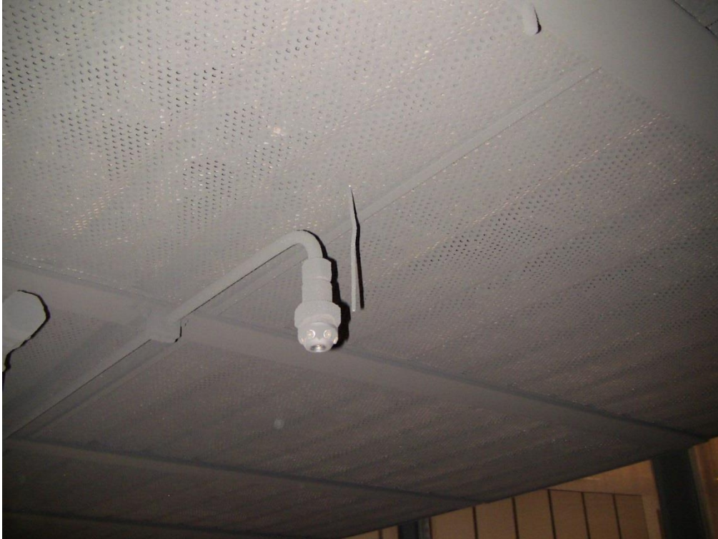
Kuva 5. Lämpötilamittaus sammutusjärjestelmän suuttimen vieressä välikaton alapuolella.
