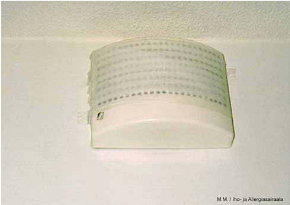
Kuva 14. Asukkaan teippaama koneellisen tulo- ja poistoilmanvaihdon tuloilma-venttiili.
