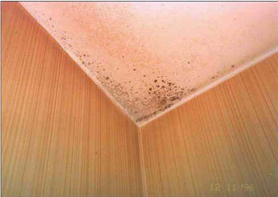
Kuva 11. Puutteellisesta ilmanvaihdosta johtunut kosteusvaurio kylpyhuoneen katossa.
