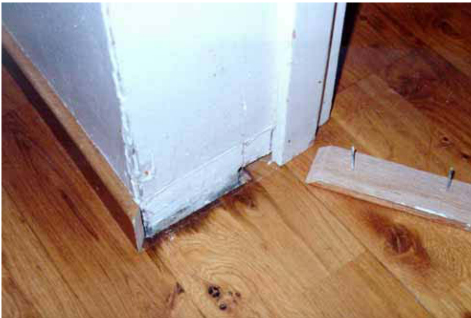
Kuva 12. Parketin tummumista alapuolisesta lattiamateriaalista päässeen kosteuden aiheuttamana.
