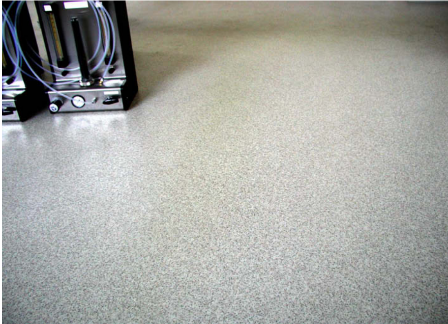
Kuva 3. Värjäytynyt PVC-pinnoite ongelmakohteessa 3.
