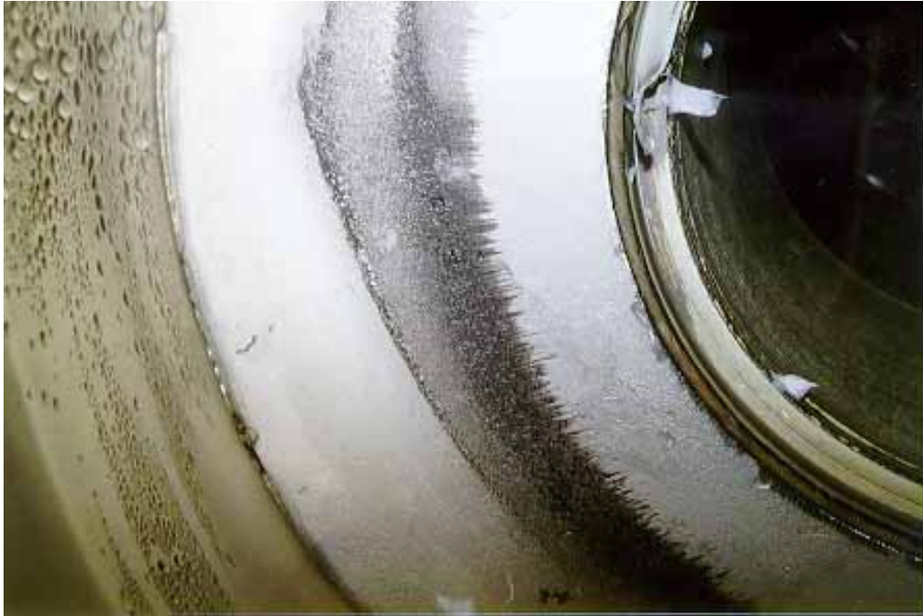
Kuva 8. Massan syöttöputkessa havaittua pistekorroosiota.
