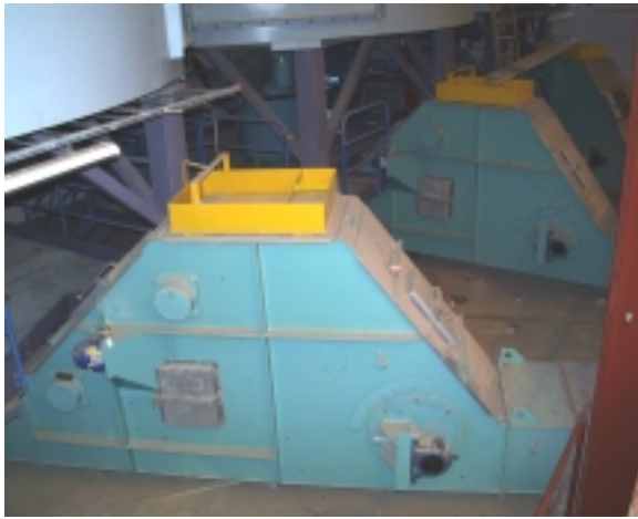
Kuva 2. Materiaalivirran tasaimet ovat kiinteän polttoaineen sisäkäsittelyjärjestelmässä Stockholms Energi AB:lla, Ruotsissa.
