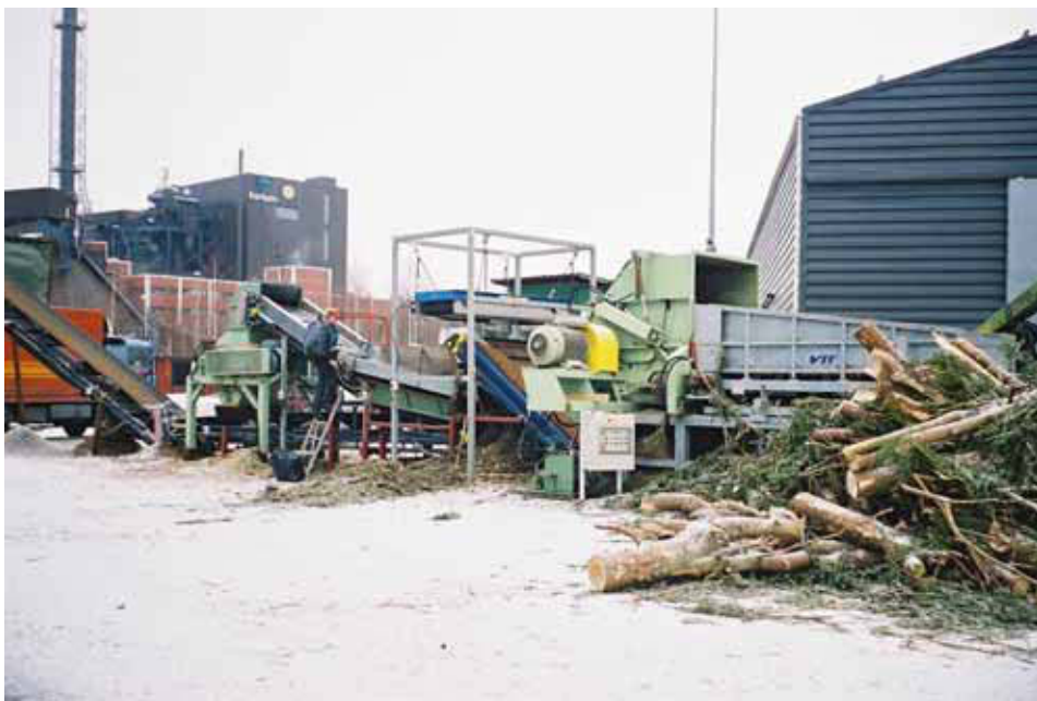
Kuva 1. Kaksivaihemurskainlinjasto VTT:llä muutostöiden jälkeen.
