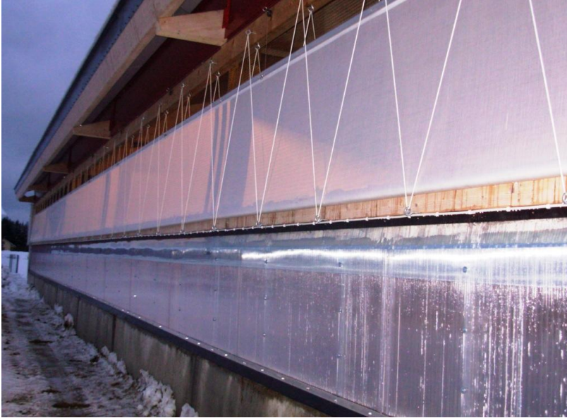
Kuva 77. Tuloilma-aukko. Verhoseinä auki yläosastaan noin 30 cm.
