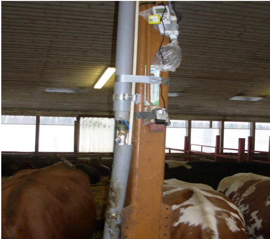
Kuva 114. Mittausanturit (lämpötila, kosteus ja CO 2 ).
