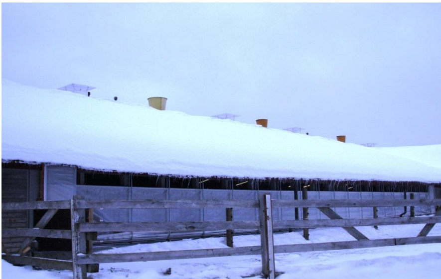
Kuva 111. Verhoseinä auki yläreunastaan noin 40 cm.
