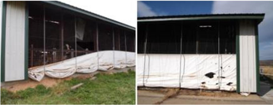
Kuva 127. Kahdeksan vuotta vanha pohjoisamerikkalainen pihatto, jossa nosto- mekanismi on vaurioitunut ja verhomateriaali osin repeillyt.
