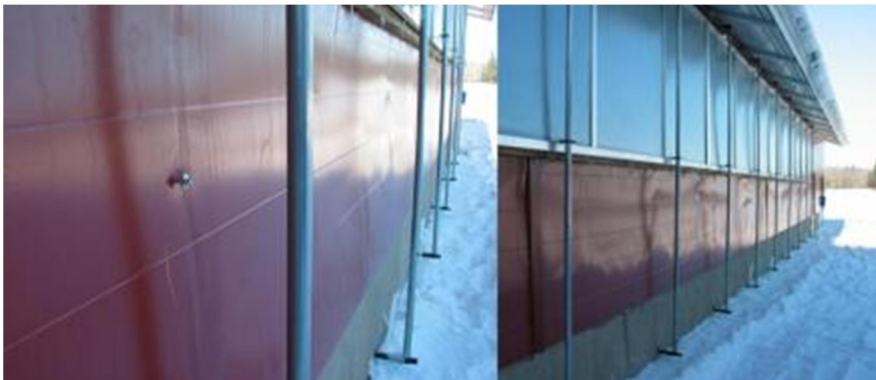
Kuva 132. Kennolevyalueen alapuolisen seinän lämpötila on noussut kesällä korkeaksi ja aiheuttanut pintapellin vääntyilemisen ja kasetin kiinnitysruuvien kirkauksen.
