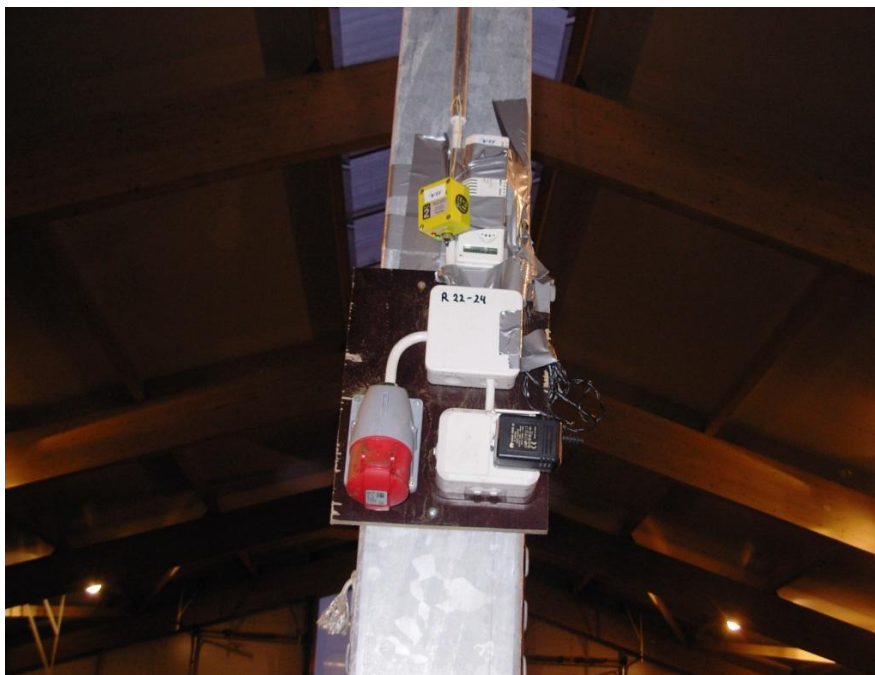
Kuva 80. Mittausanturit (lämpötila, kosteus ja CO 2 ).
