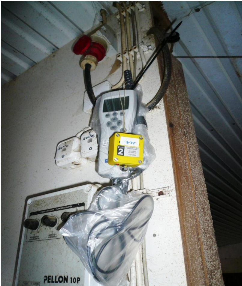
Kuva 89. Mittausanturit (lämpötila, kosteus ja CO 2 ).
