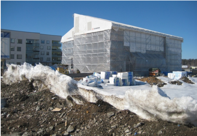
Kuva 73. Rakennuksen sääsuojaus on kattava, mutta materiaalien suojauksesta ei ole huolehdittu.
