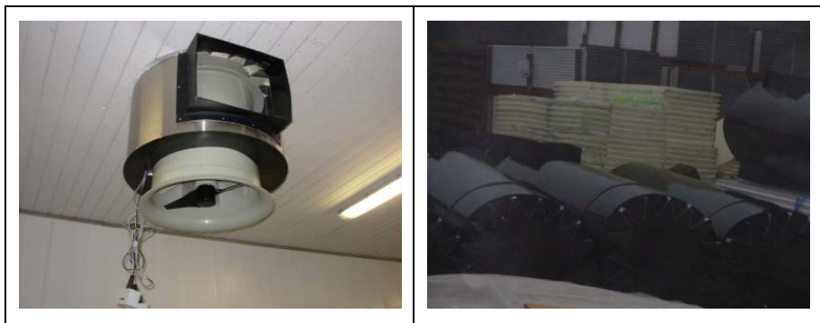
Kuva 25. Poistopuhallin ja siihen liitetty lämmöntalteenottolaite. Vasemmalle avautuvaan kehykseen liitetään tuloilmakanava. Poistoilma virtaa puhaltimen putkeen alhaalta.
