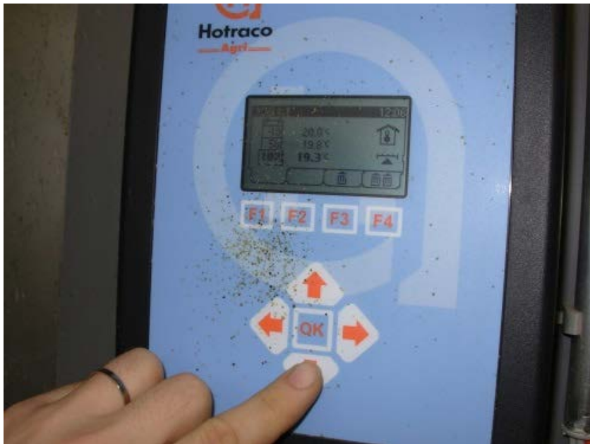
Kuva 8. Lämmityksen ja ilmanvaihdon ohjauksen päätelaite.
