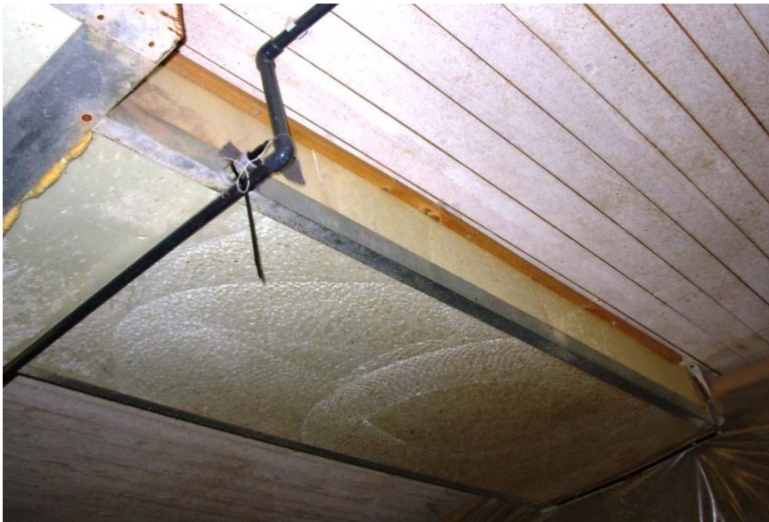
Kuva 23. Tuloilmakanava (polystyreeni) LTO:n jälkeen. Kuvassa näkyy myös lämpötila-anturi.
