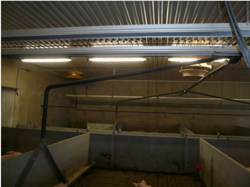
Kuva 36. Lämmityspatterit (nk. twin-patterit) osaston yläpuolella.
