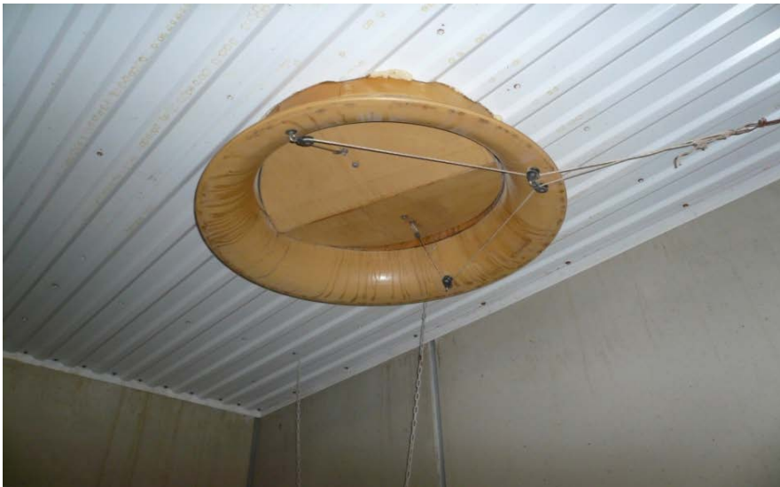
Kuva 34. Poistoilmahormi. Ilmanvaihto minimiasennolla.
