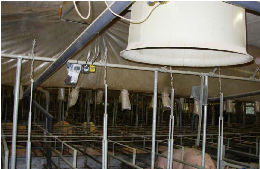
Kuva 22. Poistoilmapuhallin etualalla. Seurantamittareita näkyy kiinnitettyinä teräskanokoon.
