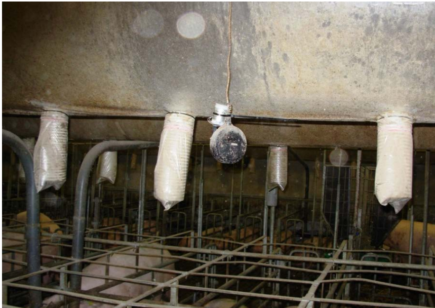
Kuva 24. Tuloilmakanavana toimiva putkimainen muovi. Alaosassa olevien pienten putkien kautta tuodaan ilma osastolle kesällä. Edessä osaston lämpötilamittari ja vieressä VTT:n lämpötilamittari.
