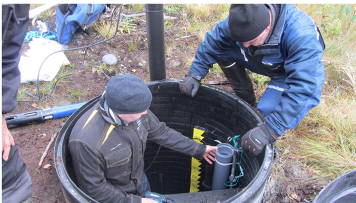
Kuva 38. EXO2-mittalaite asennettiin pintavalutuskentän ylä- ja alapuolelle, kuvassa pintavalutuskentän alapuolinen mittakaivo.
