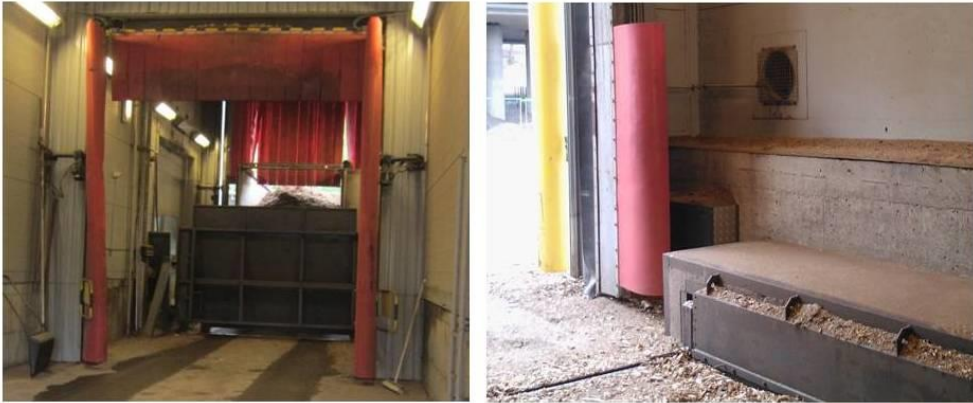
Kuva 27. Hakkeen purkupaikka Naistenlahden voimalaitoksella.
