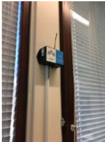
Kuva 55. Telian Cloudgate-tukiasemat ja Monnit Alta -paine-erosensorit ovat käytössä paine-erojen mittauksessa kohteissa.
