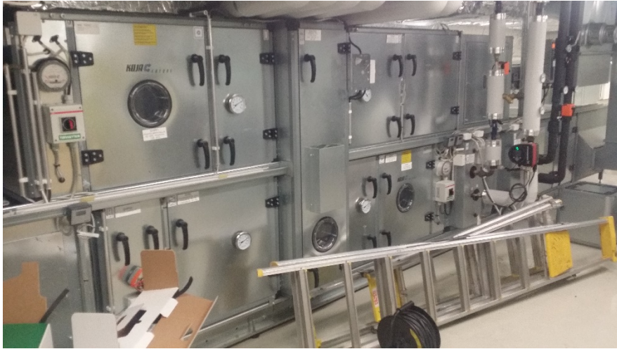
Kuva 35. Stadin ammattiopisto Meritalon perusparannuksessa vuosina 2013–2014 asennettu ilmanvaihdonkone.
