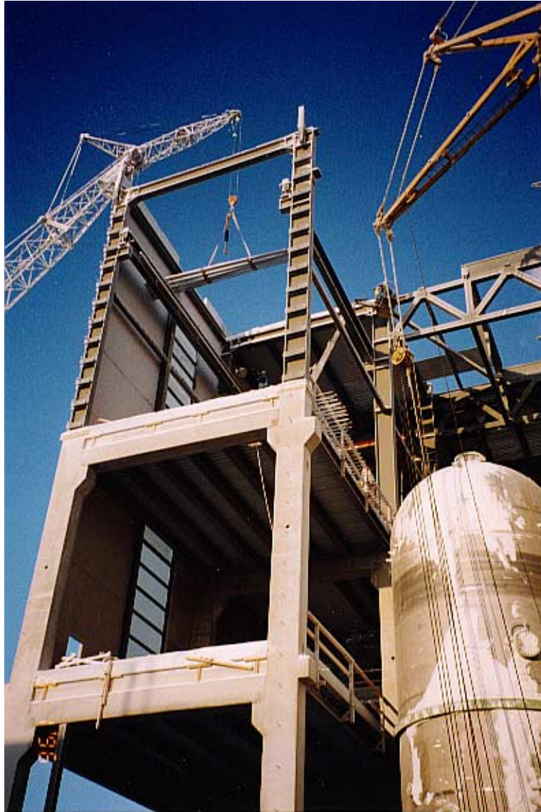
Kuva13. Rakennustyömaalla on aukkoja, joista voi pudota. Aukon suojaaminen aidalla on joissain tapauksissa hankalaa, kun tavaroita tuodaan jatkuvasti sisään näistä aukoista.
