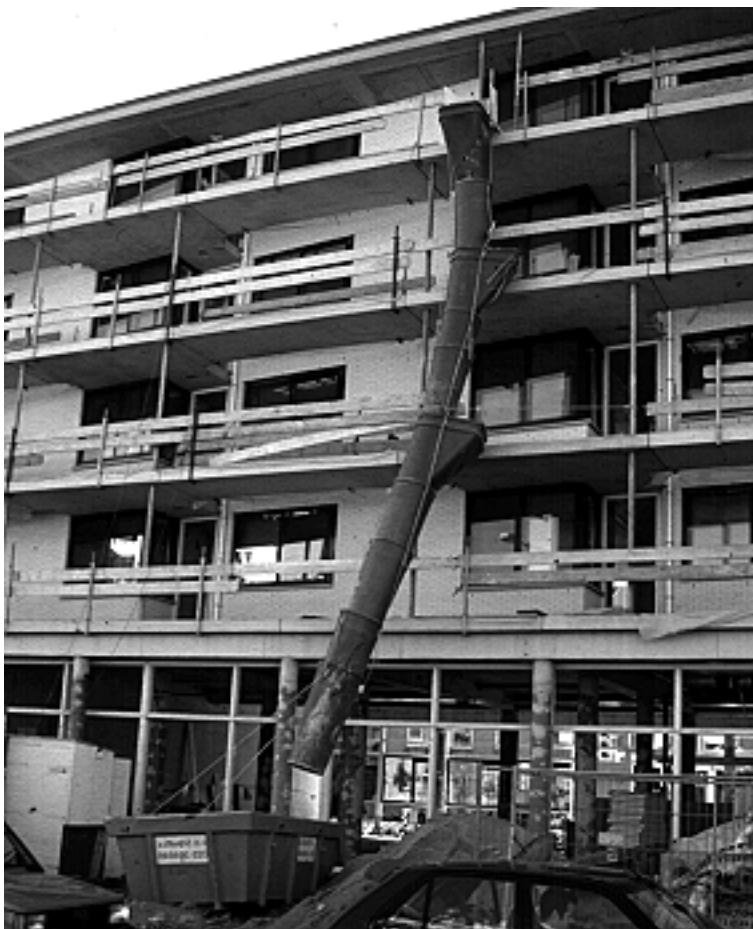
Kuva 5.4. Jätekuilun käyttö luhtikäytävälössä (Amsterdam, Hollanti).
