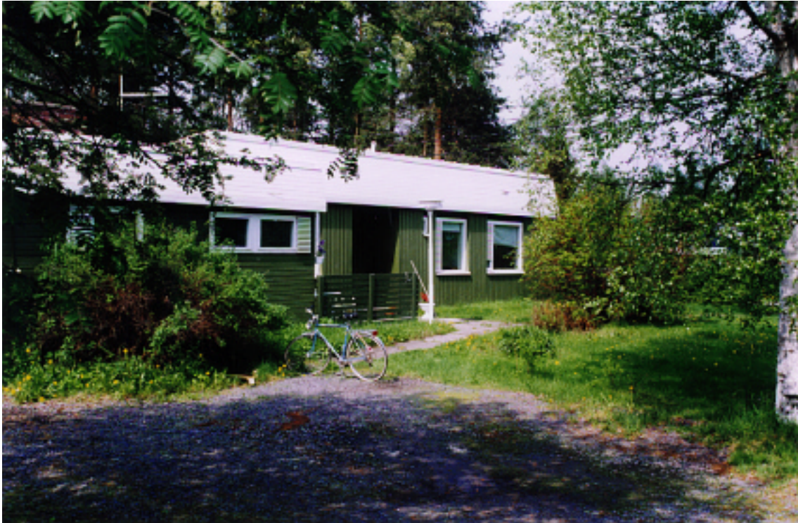
Kuva 3. Uudempi rakennus, jossa on jo nähtävissä riskitekijöitä. Perustus on erittäin matalalla ja rakennuksen ulkopuolen maanpinnan kallistukset ovat puutteelliset. Myös räystäät puuttuvat.
