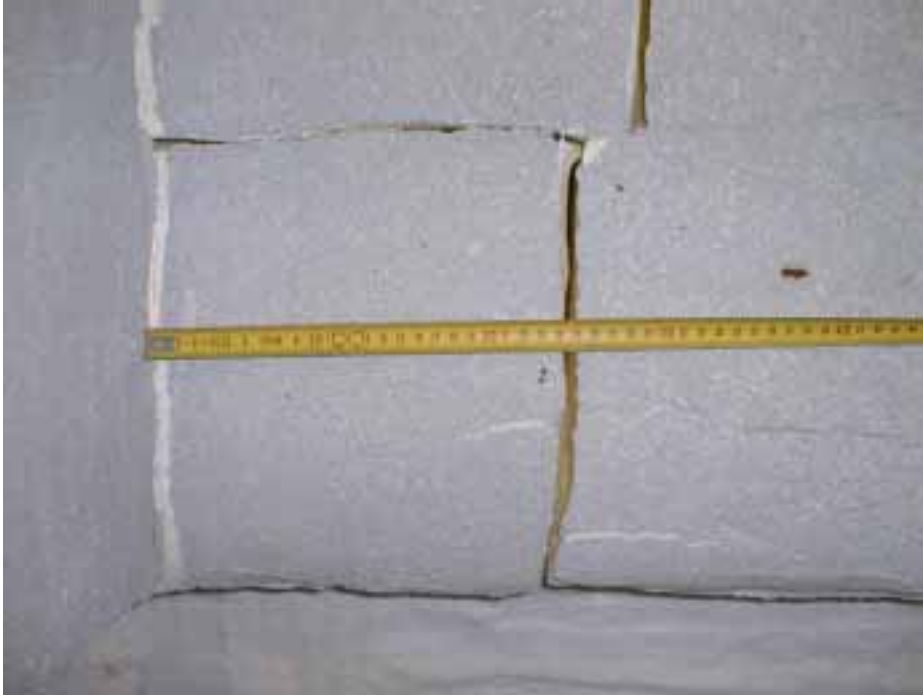
Kuva 8. Poltinseinän vasemman puolen Pyrobloc-rakenteessa oleva pystysuora särö lähikuvassa. Mittanauhan mukaan arvioituna leveys on lähes 10 mm.
