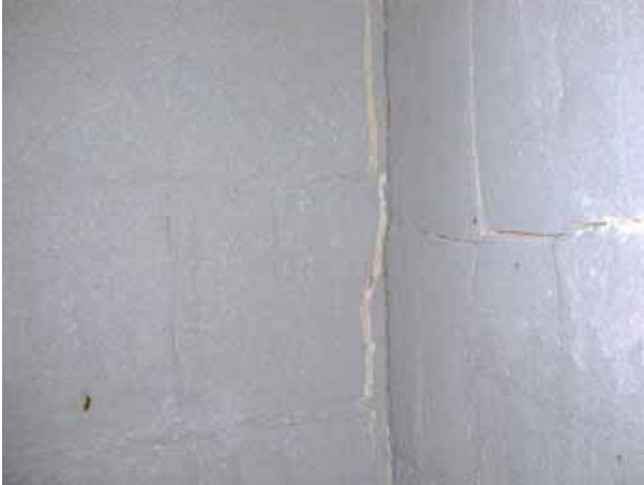
Kuva 20. Poltinseinän ja oikean seinän välinen särjä yhden korkealämpötila-ajon (1 400 °C) jälkeen. Uusi särö on syntynyt pääasiassa yhden kuituhuovan leveyden verran aiemmasta säröstä vasemmalle.
