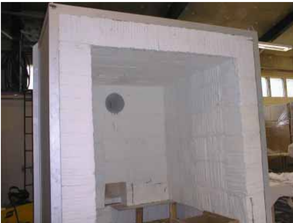
Kuva 13. Yleiskuva uunin sisätiloista (ennen pinnoitusta ja testiajoja).
