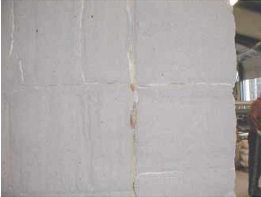
Kuva 4. Oikean seinän oikean puoleista reunaa, Prismobloc-moduuleja, noin viikon katkonaisen koeajojakson jälkeen. Kuvassa on pystysuorassa iso särö kohdassa, jossa moduulien suunta muuttuu (vasemmalla huovat pystysuorassa, oikealla vaakasuorassa). Muut säröt ovat pieniä.
