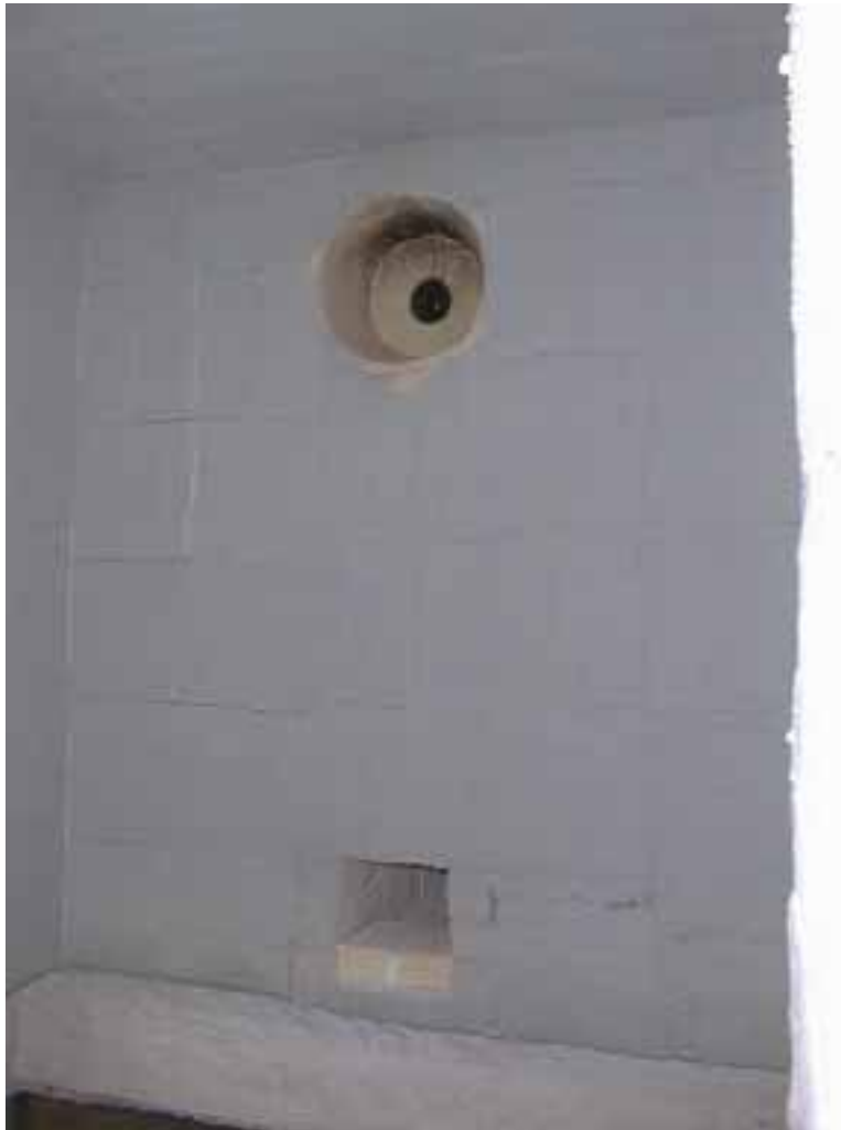
Kuva 1. Poltinseinä sen jälkeen, kun uuni oli käynyt ensimmäisen kerran lähellä 1 300 °C:ta. Vasemmalla Pyrobloc-moduulit, oikealla Prismoblocit. Selkeimmin havaittava särö on vasemmalla puolella noin polttimen ja vasemman seinän puolivälissä oleva pystysuora särö. Muut säröt ovat vielä melko vähäisiä. Vaakasuorat säröt näkyvät kuvassa ”liian selvästi”, mahdollisesti valaistussyistä.
