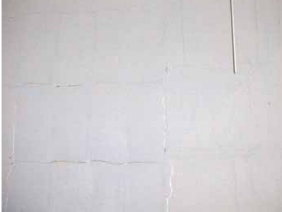
Kuva 2. Uunin sisäosaa kahden lyhyen koeajoyritteen jälkeen, kun uuni oli käynyt kaksi kertaa muutaman tunnin ajan 1 300 °C:n seutuvilla. Oikean seinän vasemmalla puolella on selkeitä säröjä näkyvissä. Katon läpi työnnetyn termoelementin suojaputket ovat katkenneet ja tipahtaneet.
