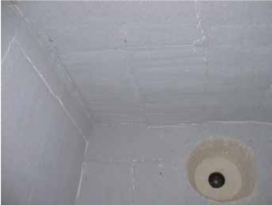
Kuva 6. Uunin poltinseinän, vasemman seinän ja katon välinen nurkka. Sivuseinän yläosassa on suurehko vaakasuora särö, samoin poltinseinän ja vasemman seinän välissä. Myös poltinseinän vasemman puolen pystysuora särö on näkyvissä. Katon säröt ovat pieniä
