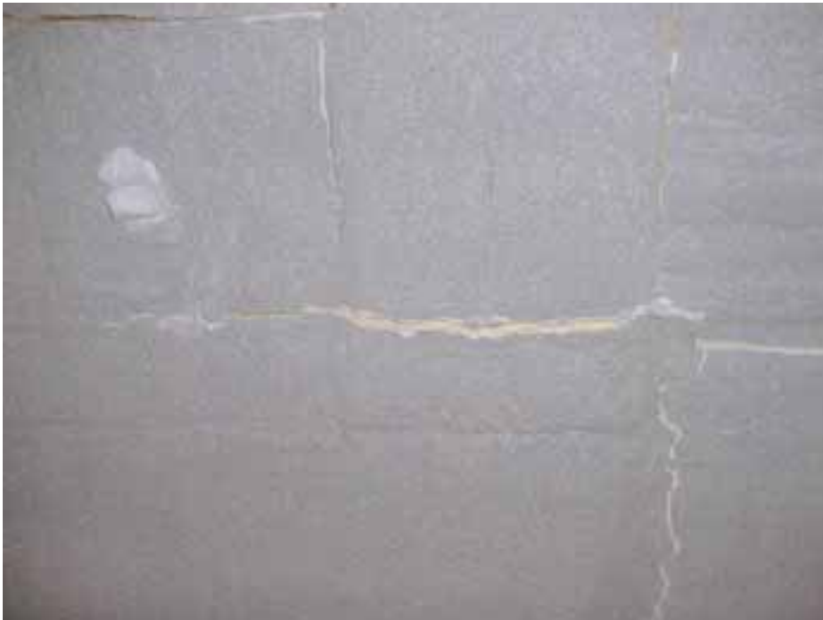
Kuva 21. Uunin kattoa kahden ajon (yhteensä n. 12 tuntia 1 400 °C:ssa) jälkeen. Säröt ovat jonkin verran kasvaneet, ja paikatun kohdan viereen on syntynyt uusi särö.
