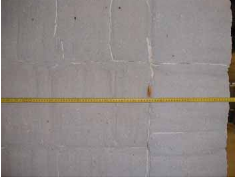
Kuva 10. Oikean seinän luukun puoleista osaa, Prismobloc-rakennetta kahden viikon koeajojen jälkeen. Säröt ovat samoissa kohdin kuin aiemmin kuvassa 4.
