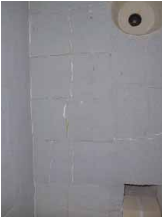
Kuva 3. Poltinseinän vasen puolin noin viikon katkonaisen koeajojakson jälkeen. Pystysuora särö Pyrobloc-moduulien välissä on kasvanut silmiinpistäväksi isoksi. Myös vaakasuorat säröt ovat kohtalaisia.
