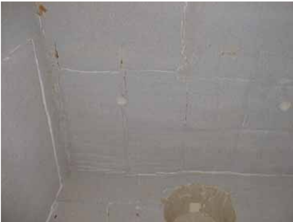
Kuva 13. Etupäässä kattoa kahden viikon koeajojen jälkeen. Katossa ei ole isoja säröjä.
