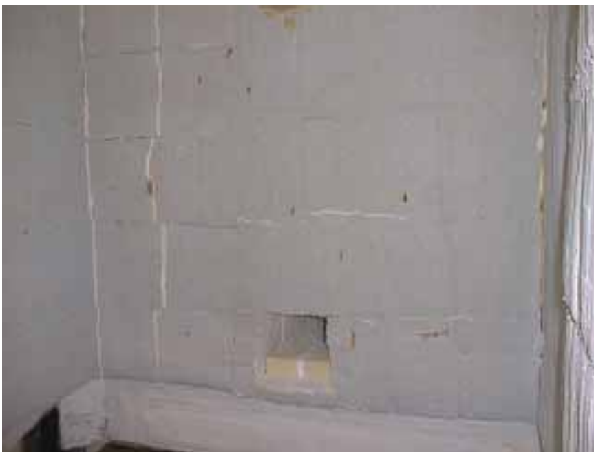
Kuva 7. Yleiskuva poltinseinän alaosasta kahden viikon koeajojen jälkeen 1 300 °C:ssa. Vasemman puolen pystysuora särö sekä oikeassa kulmassa oleva särö ovat todella suuria verrattuna muihin säröihin.
