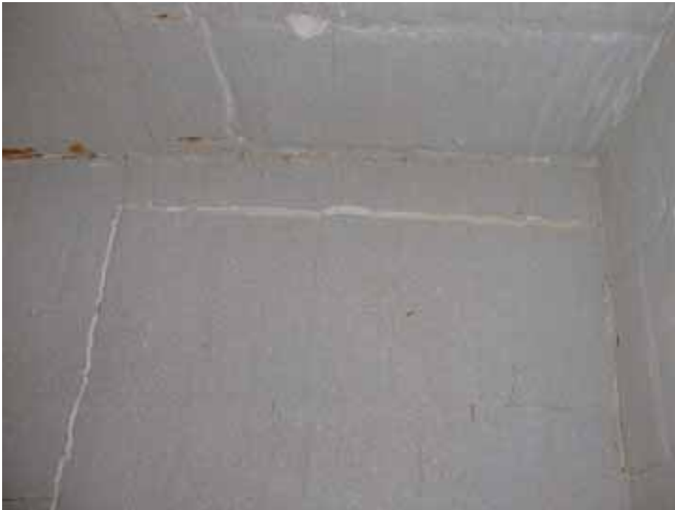
Kuva 11. Vasen seinä ja vähän kattoa kahden viikon koeajojen jälkeen. Katon lähellä oleva särö on ”iso”, seinän keskellä pystysuora särö ”kohtalainen”, muut säröt pieniä.
