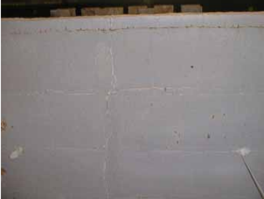
Kuva 14. Katon etuosan liimattuja rakenteita kahden viikon koeajojen jälkeen. Säröt ovat pienehköjä.
