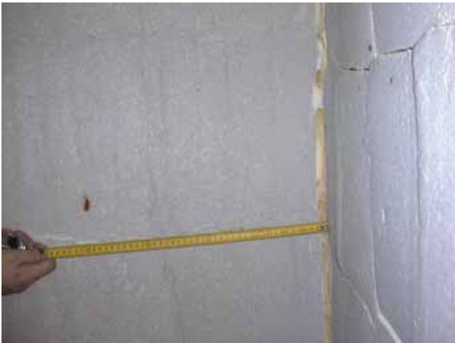
Kuva 9. Poltinseinän ja oikean seinän kulmassa oleva iso rako lähikuvassa. Myös oikean seinän Pyrobloc-moduulien väliset säröt näkyvät hyvin.
