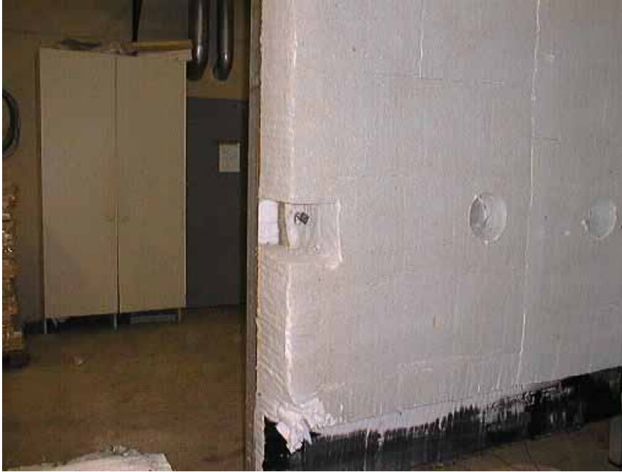
Kuva 16. Vasenta seinää sen jälkeen, kun uunilla on ajettu kahden viikon koeajot 1 300 °C:ssa ja otettu näytteitä. Osa näytteistä otettiin kairaamalla (oikean puoleiset pyöreät reiät), yksi veitsellä.
