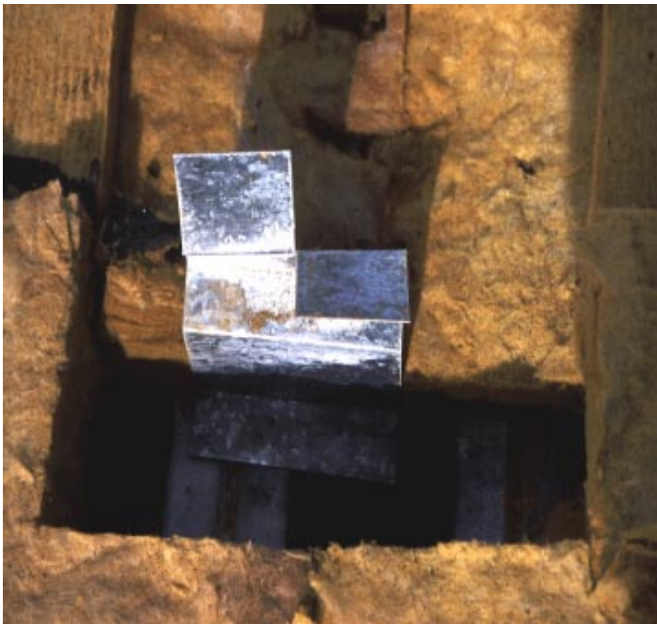
Kuva 23. Lämmöneristeen kiinnike ilman höyrynsulkua tehdyssä poimulevykatossa.
