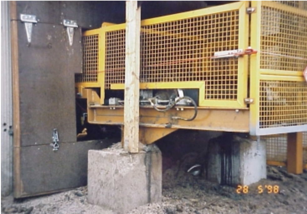
Kuva 18. Kuljettimen suojaamaton taittopää. Karisteen poisto on hankalaa ahtaista väleistä ja seinän vierestä.
