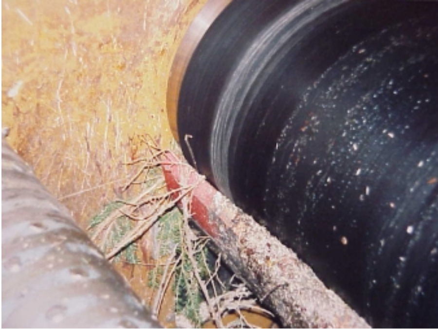
Kuva 17. Kuljettimen esipuhdistimen ja hihnan tai rummun väliin on kiilautunut oksia hieman liian pitkän puhdistimen vuoksi.
