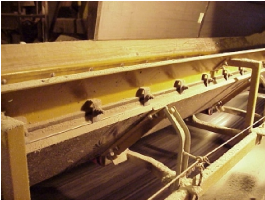
Kuva 20. Vaikeasti säädettävä tiivistyskumin kiinnitysmekanismi.
