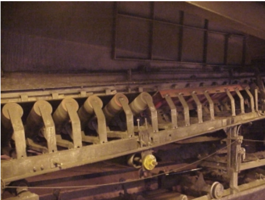
Kuva 15. Suojaamattomia kannatusrullien nieluja.
