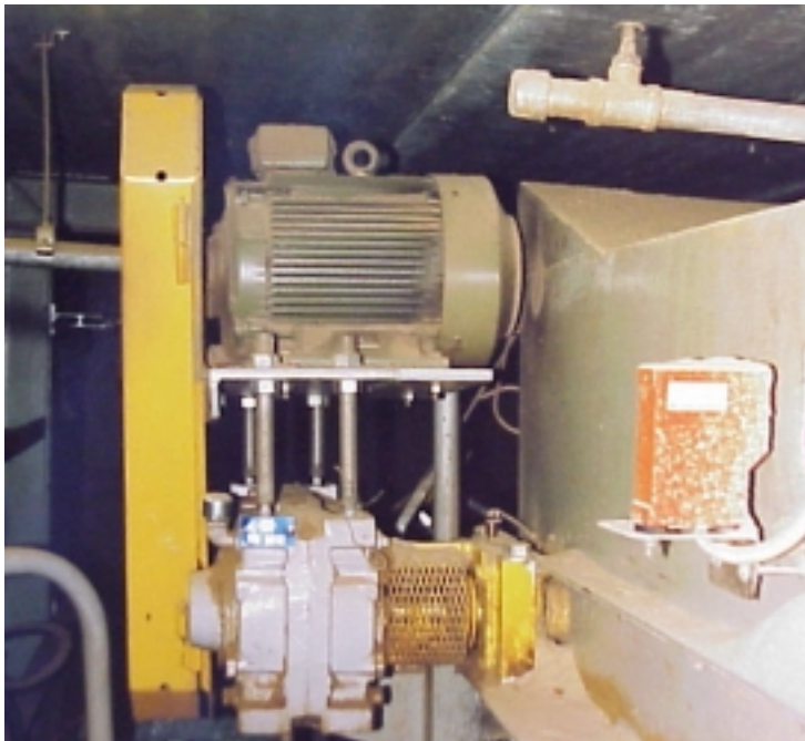
Kuva 19. Kuljettimen vetopää sijoitettuna paikkaan, jossa lähellä oleva katto ja sprinklerputket hankaloittavat käyttökoneiston ja vetorummun vaihtoa.
