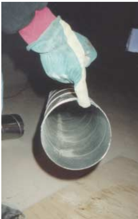
Kuva 11. Kulmahiomakoneen käytöstä kanavan sisälle levinyttä rautapölyä.
