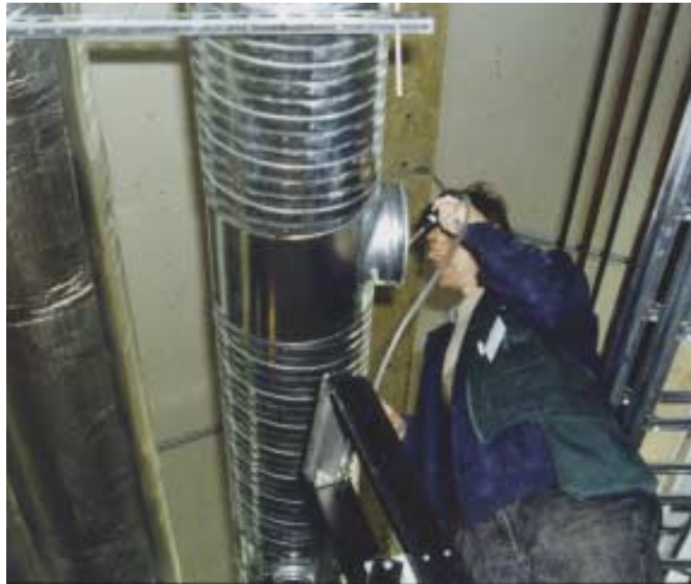
Kuva 7. Kanaviston sisäpuolisen pölykertymän mittaus rakennustyömaalla.
