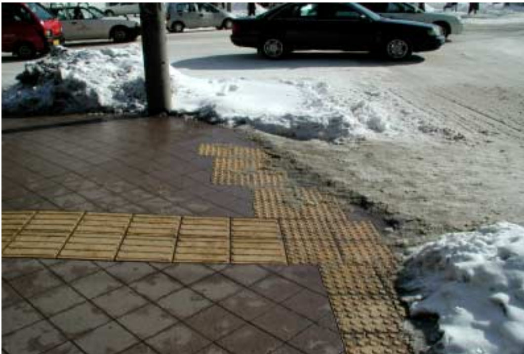
Kuva 2. Lämmitetty jalkakäytävä, jossa lämmittämättömän suojatien kohdalle on asennettu liukastumista estävä laatoitus, kuva Sapporosta.
