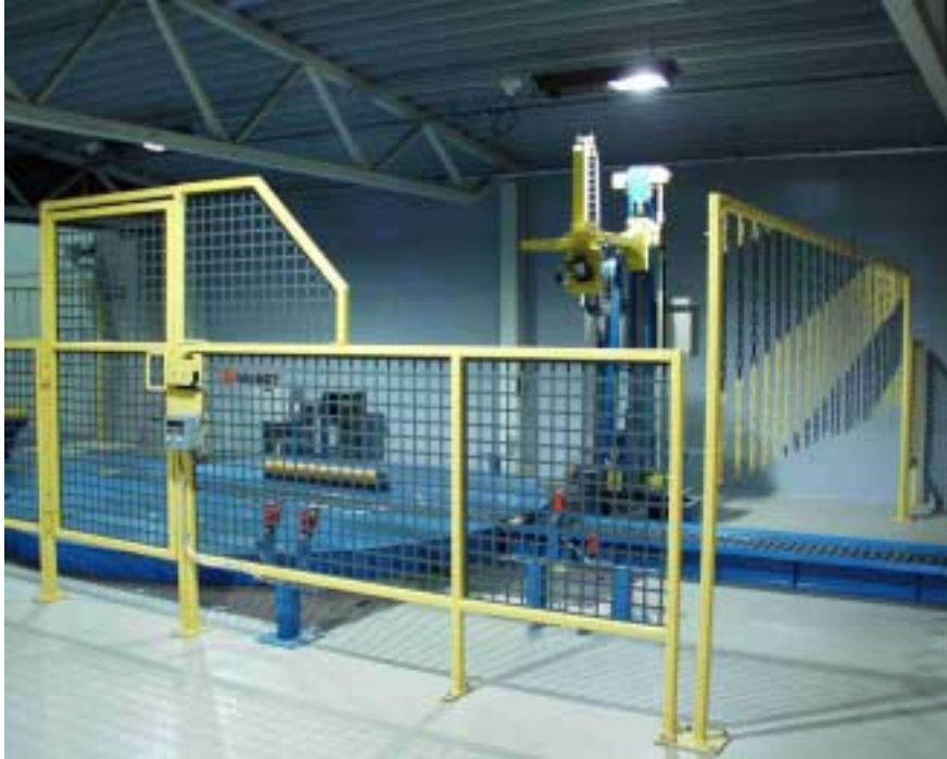
Kuva 29. Vierekkäin olevat paperirullien kulkuaukko ja henkilöliikennettä varten oleva toimintaan kytketty portti.
