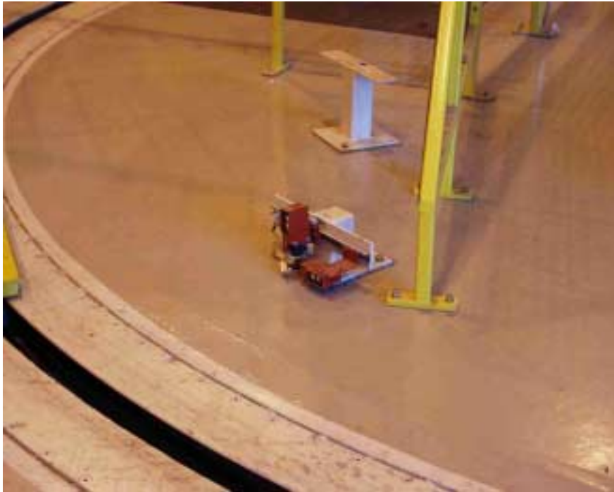
Kuva 23. Kuljetinjärjestelmän automatisointiin liittyvä valokenno.
