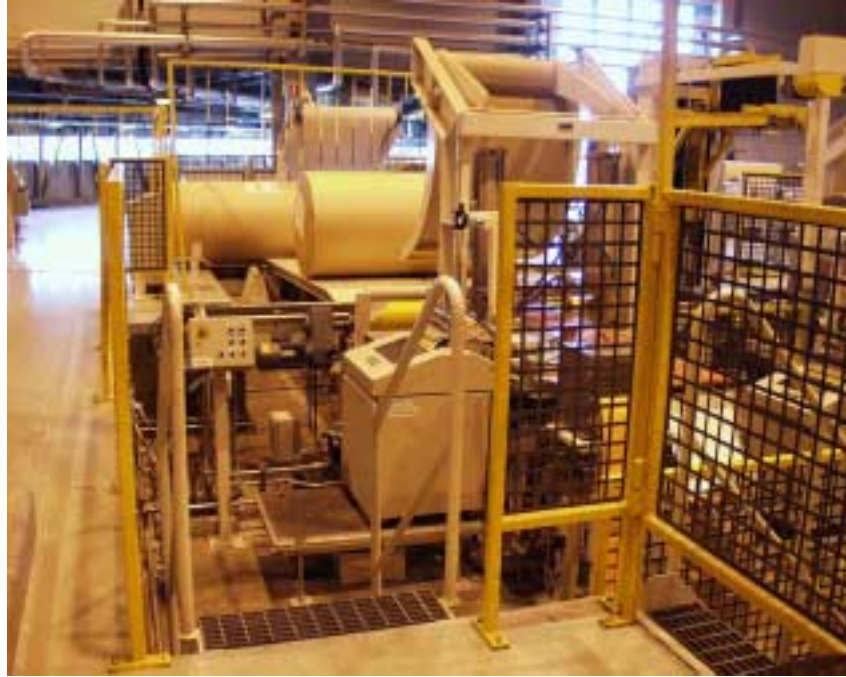
Kuva 25. Etiketöintilaitteille vievät portaat, josta pääsee vapaasti pakkauskoneen vaaravyöhykkeelle.
