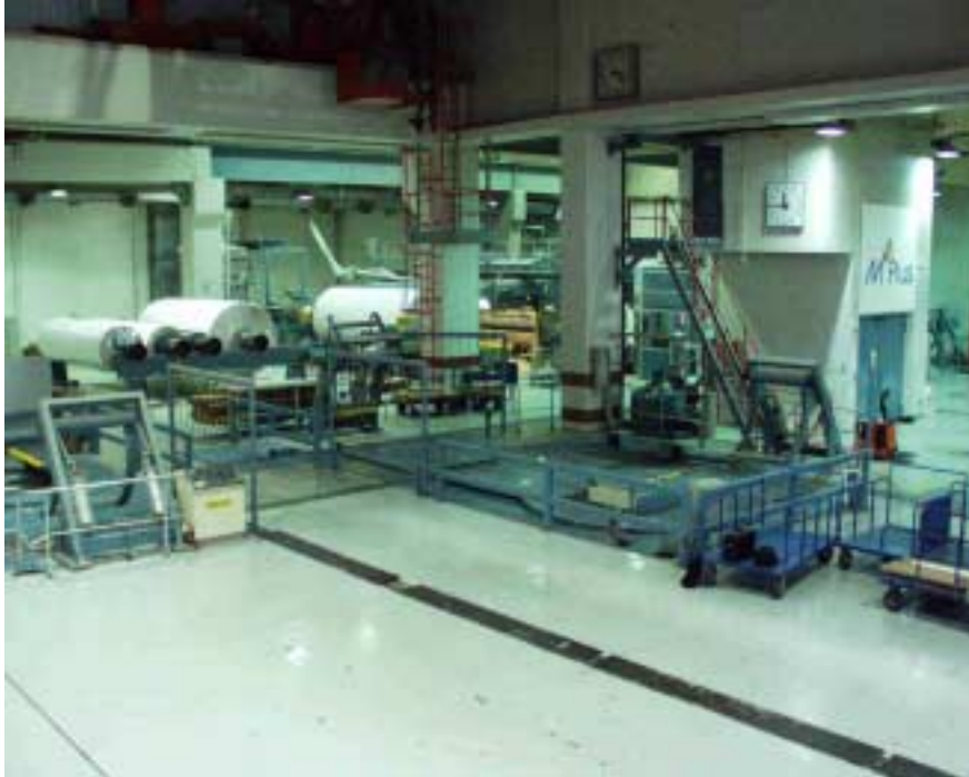
Kuva 11. Kuljetinjärjestelmän kääntöpöytiä ja niihin liittyviä pysäyttimiä.
