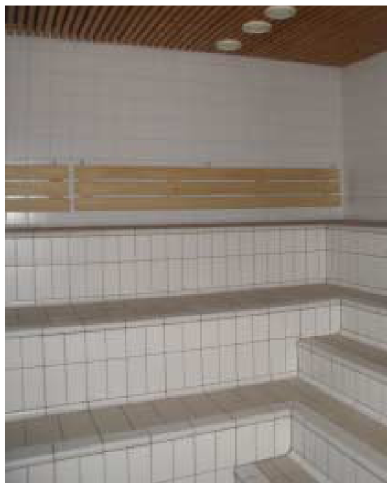
Kuva 10. Kaakelilauteet voivat tulla epämiellyttävän kuumiksi varsinkin, jos jäähdytys ei toimi kunnolla. Korkeat porrasaskelmat ja kaiteiden puuttuminen tekevät liikkumisen turvattomaksi.
