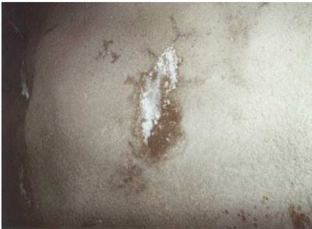
Kuva 2. Kosteaa aluetta seinäpinnalla. Vaalea alue on kalkkisaostumaa.
