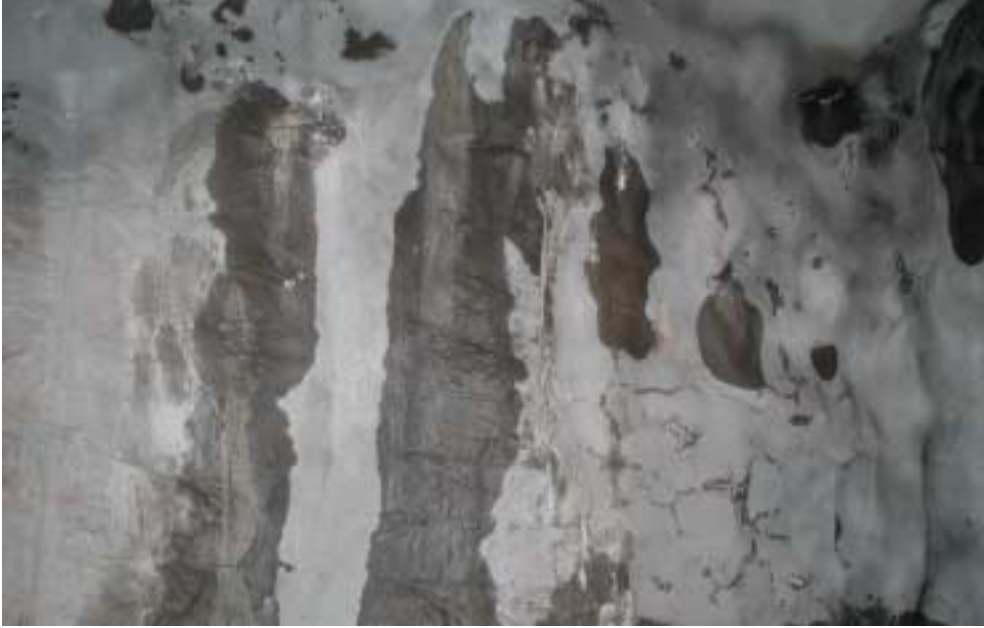
Kuva 41. Yleinen ilmiö ruiskubetonin salaojituksessa. Salaojan kohta on kuiva ja vesi purkautuu salaojan sivuilta. Tässä tapauksessa vuotoihin osaltaan vaikuttaa työnaikaisen ruiskubetonin puuttuminen salaojan sivuilta, toisaalta salaoja ei myöskään toimi suunnitellusti.
