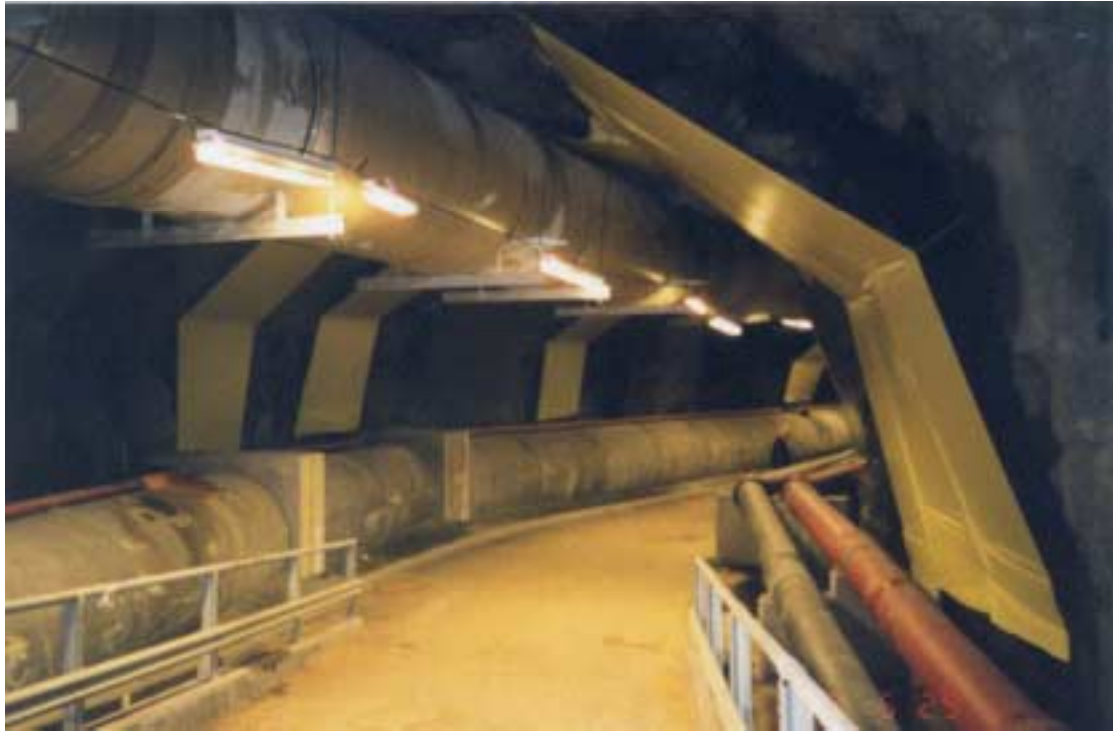
Kuva 8. Norjan Bergenissä kaukolämpötunnelissa toteutettu paikallinen kangasverhous-rakenne. Vastaavia rakenteita Vuosaari–Pasila kaukolämpötunnelissa.
