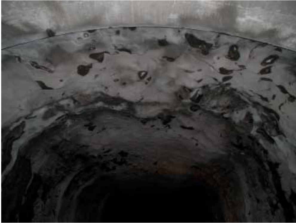
Kuva 39. Pohjoistunnelin länsipään suuaukon rikkonainen kallio on johtanut epätasaiseen louhintajälkeen ja aiheuttanut runsaita vesivuotoja. Kuvan yläaidassa suuaukon kauluksen betonirakenteita.
