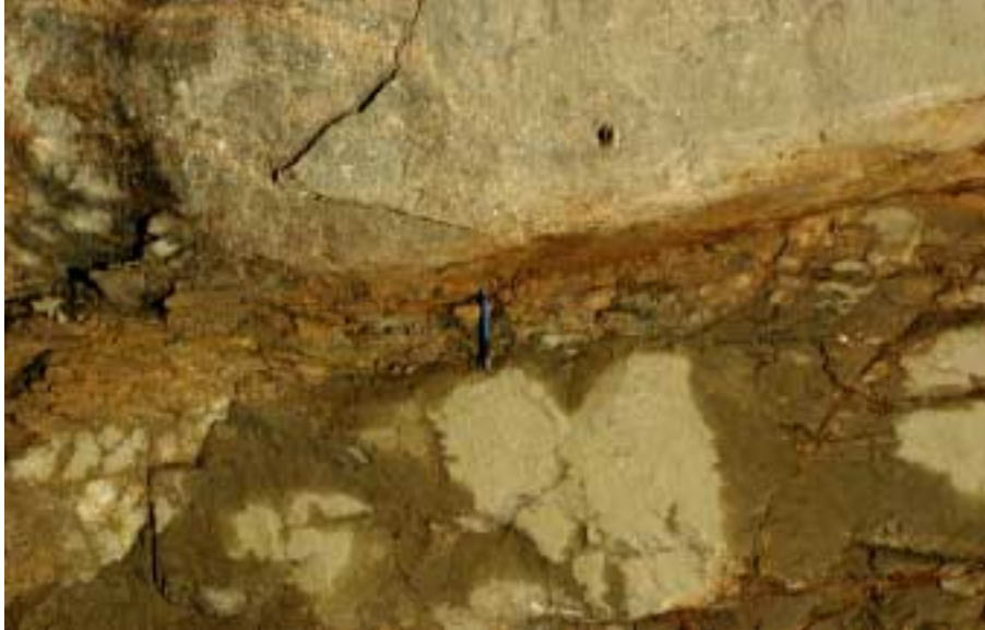
Kuva 37. Isonkylän pohjoistunnelin tutkimusalueen paaluväliä 93950-975 hallitsee loiva-asentoinen koko tunnelia leikkaava kloriitista ja savimaisista kerroksista koostuva 0,2–1 m rikkonainen vyöhyke (RiIII-IV). Kosteutta esiintyy koko vyöhykkeen pituudelta.
