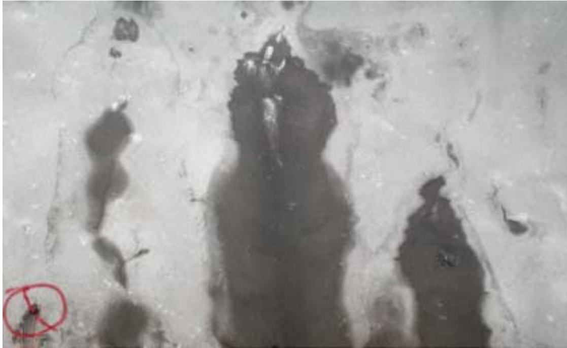
Kuva 36. Viikinmäen hallin 9 holvin ruiskubetonisalaojista johdetaan vesi ulos tasolla n. +3 ruiskubetonin läpi johdetusta salaojaputkesta. Vesi valuu ruiskubetonin pinnalla alapuoliseen vesialtaaseen. Kustannussyistä salaojavesiä ei haluta johtaa lattiarakenteisiin ja sieltä pumppaamoon.
