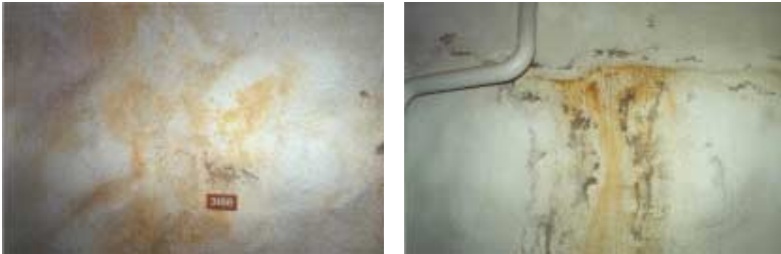
Kuva 1. Vesivuotojen aiheuttama pinnoitteen kellertyminen ja rapautuminen.
