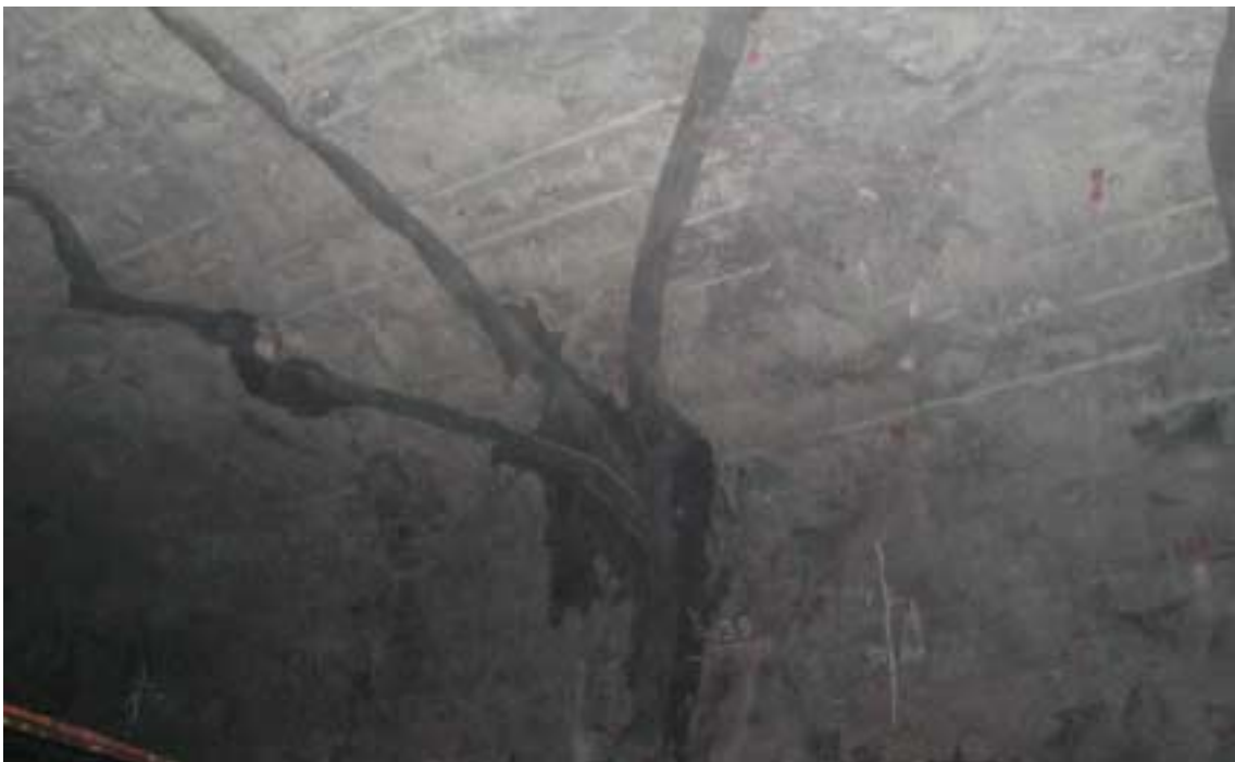
Kuva 35. Salaojien liitoskohtaan liittyy usein vuotoja, koska liitoksia ei saada tiiviiksi. Huolellisella ruiskubetonoinnilla salaojat tiivistetään toisiaan ja kalliota vasten.
