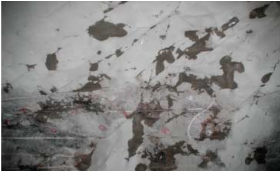
Kuva 40. Isonkylän kallion loiva-asentoiseen rakoiluun liittyvää vuotoa. Vuodot erottuvat hyvin työnaikaisen lujituksen ruiskubetonissa. Monia vuotoja on hankala salaojittaa, paksu ruiskubetonointi yhdellä keskeisellä salaojalla voisi olla vesitiiviyyden hallinnan kannalta toimiva ratkaisu.
