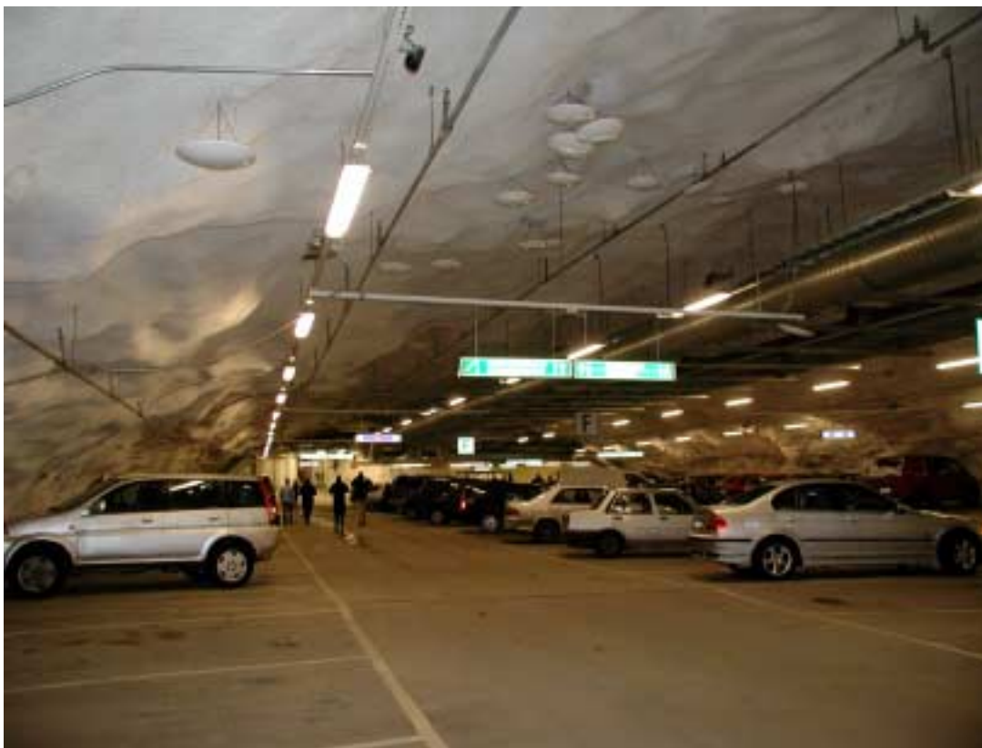
Kuva 4. Haihdutuspeltiripustuksia Kluuvin kalliopysäköintilaitoksen katossa.
