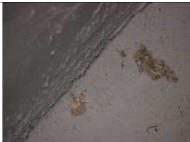
Kuva 16. Lattian rajan rako suoja-altaassa.
