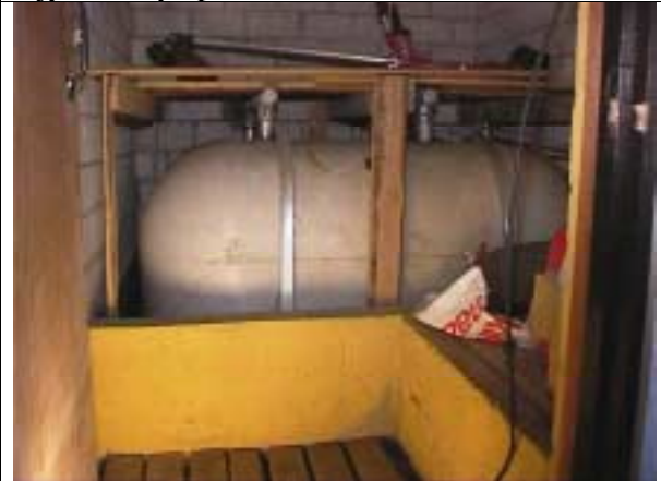
Kuva 4. Muovisen öljysäiliön suoja-allas.
