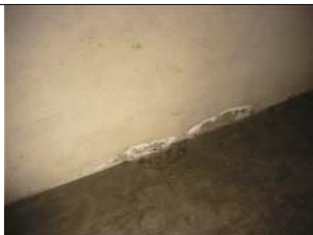
Kuva 14. Alunan muodostusta lattian rajassa kosteuden seurauksena.
