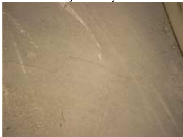
Kuva 18. Halkeama suoja-altaan lattiassa.
