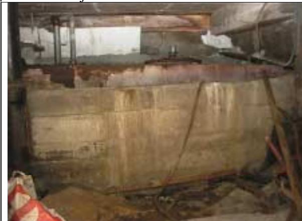
Kuva 5. Erittäin huonokuntoinen suoja-allas ja säiliörakennelma.
