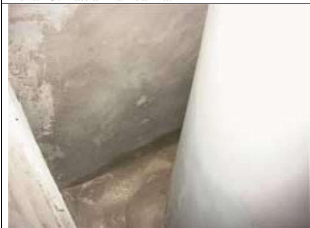
Kuva 17. Alunan muodostusta suoja-altaan rakenteissa.
