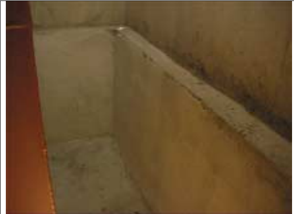
Kuva 2. Muurattu suoja-allas suorakulmaisen öljysäiliön ympärillä.
