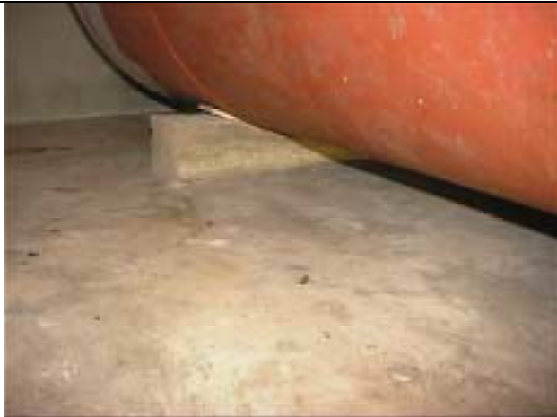
Kuva 7. Öljysäiliön alla oleva puinen tukirakenne.
