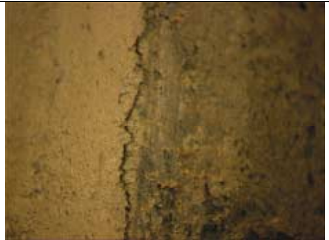
Kuva 10. Seinänurkkauksen halkeama suoja- altaassa.
