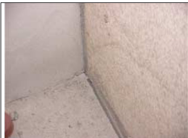
Kuva 13. Lattian ja seinän liitoksessa on rako, josta vuotanut öljy menee rakennuksen alle.
