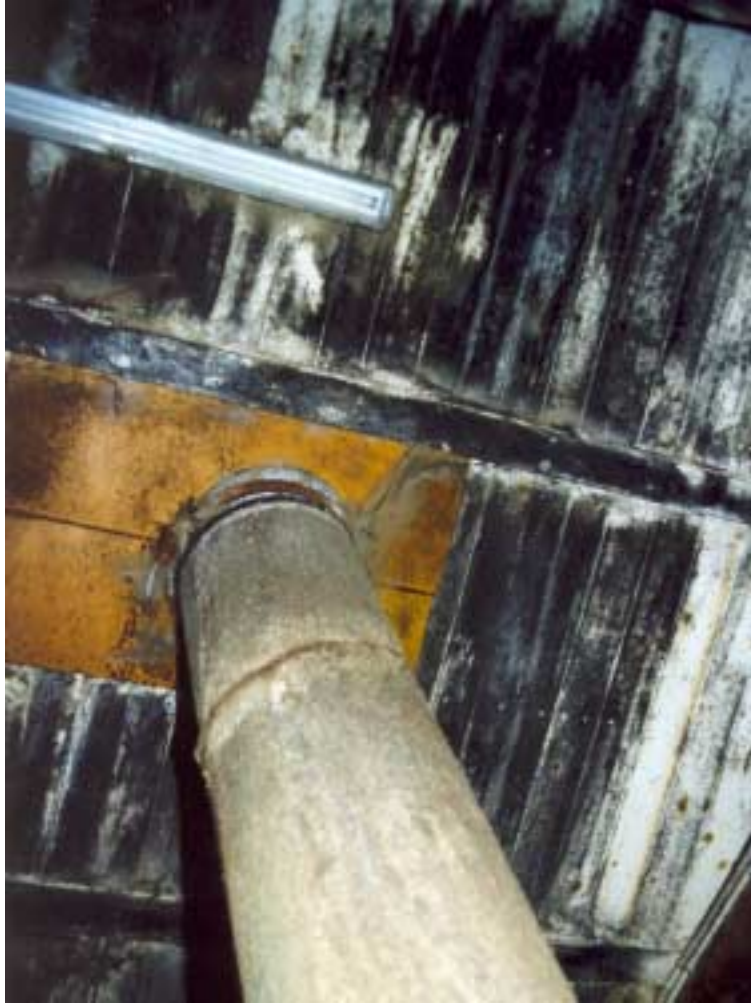
Kuva 7. Hometta katon sisäpinnassa (Pihatto 4).
