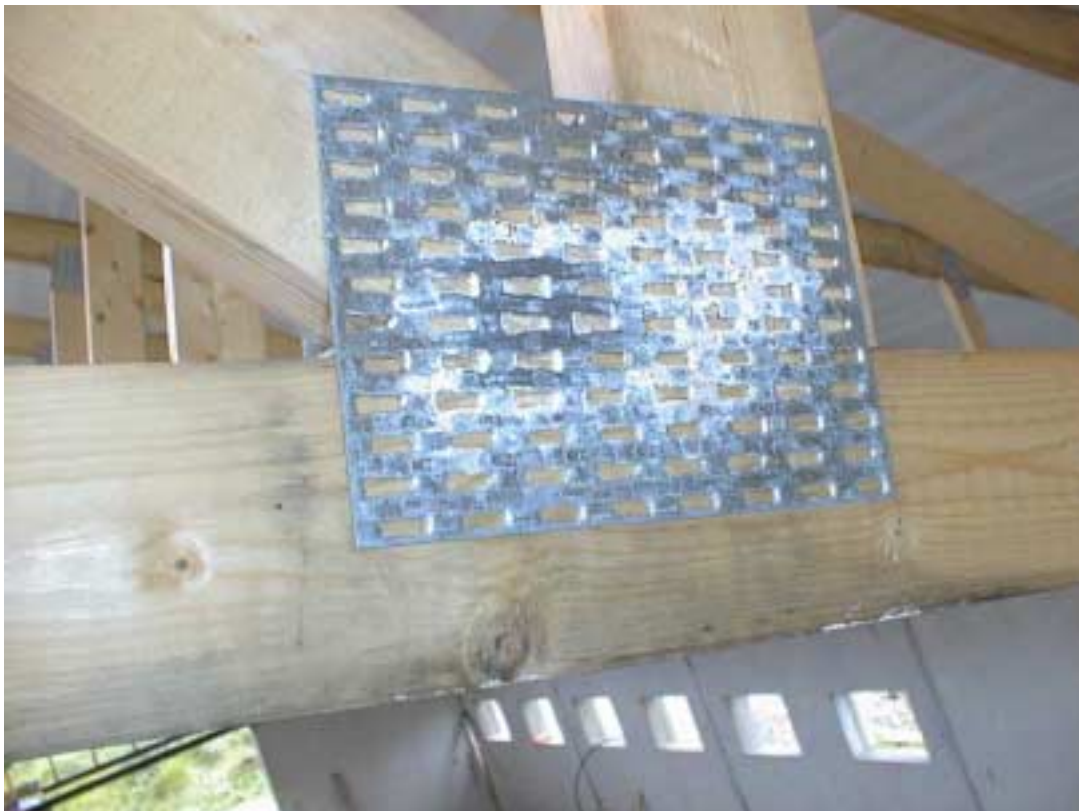
Kuva 6. Naulalevyssä olevaa valkoruostetta – rakennus on työmaavaiheessa (Pihatto 6).
