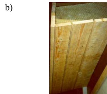
Kuva A7. Valokuvia räystäästä 2: a) räystääs edestä ja b) räystääs viistosti edestä oikealta.
