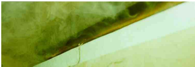
Kuva A31. Ilman ulosvirtausaukko räystäskokeessa 5: a) 8:20, aukosta ei juurikaan pur- kaudu ulos savua ja b) 17:10, vaaleaa savua virtaa aukosta ulos.
