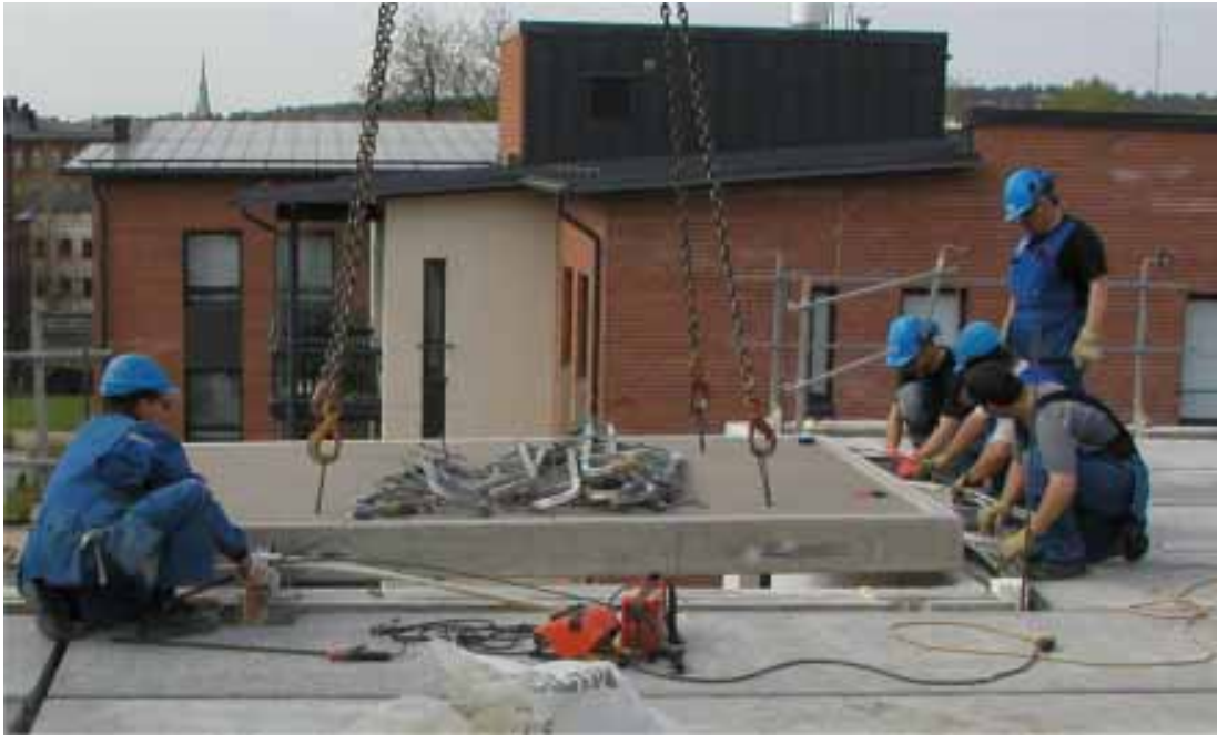
Kuva 21. Parvekeasennuksissa esiintyy usein erilaisia ongelmia, joiden ratkaiseminen vaatii paljon käsityötä.
