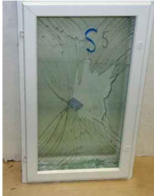
Kuva 15. Lasin sisäisen paineen aiheuttama rikkoutuminen.
