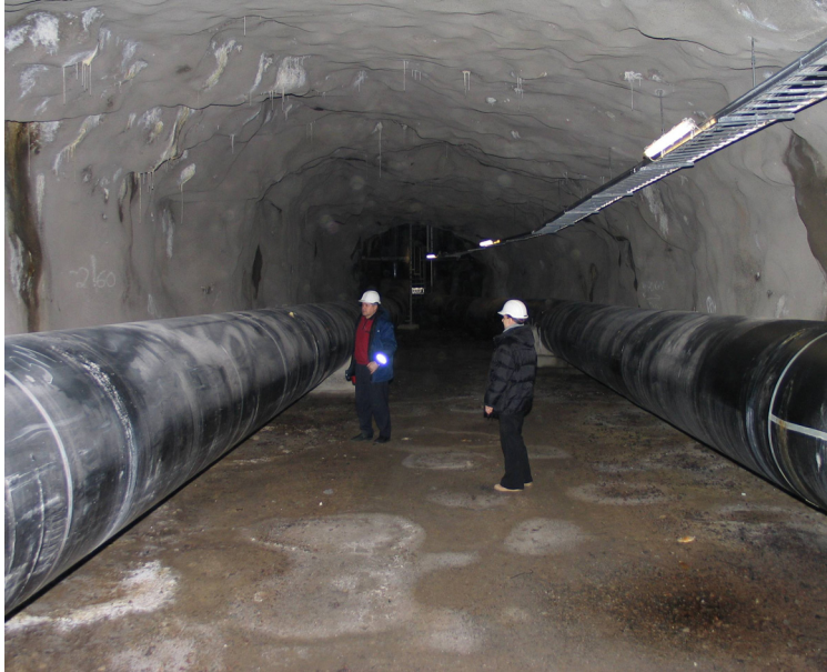
Kuva 23. Yhteiskäyttötunneli, jonka reunoilla kaukolämpöputket. Tunnelin leveys 6,7 m ja korkeus 5 m. Putket rajoittavat ajokaistan n. 3 m levyiseksi.
