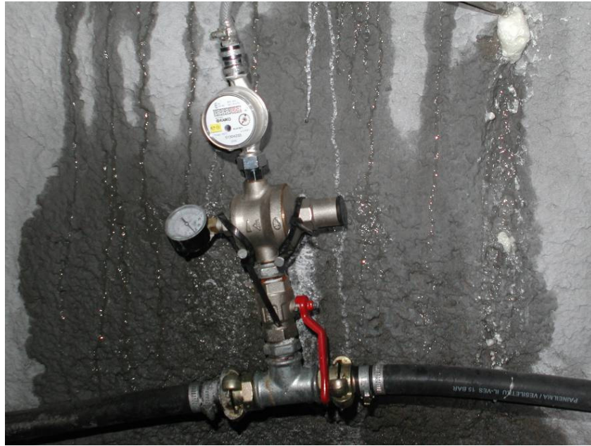
Kuva 8. Koealueiden vedenpainejärjestelmä sisältäen sulkuventtiilin, paineen säätöventtiilin ja virtaamamittarin kytkettynä ruiskubetonin taakse kalliopintaan salaojan tavoin asennettuun injektointiputkeen.
