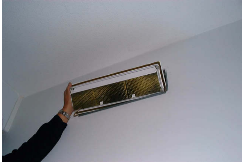
Kuva 18. Kohteen 7 tuloilmaventtiilin äänenvaimennuksessa on käytetty mineraalivillaa.
