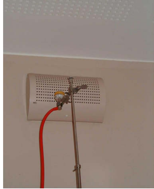
Kuva 30. Ilmanäyte tuloilmaelimen kohdalta.
