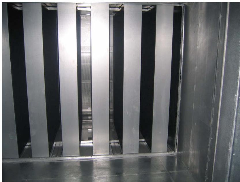
Kuva 19. Kohteen 4 ilmanvaihtokoneen lamelliäänenvaimennin, josta irtosi mineraalivillakuituja tuloilmaan.
