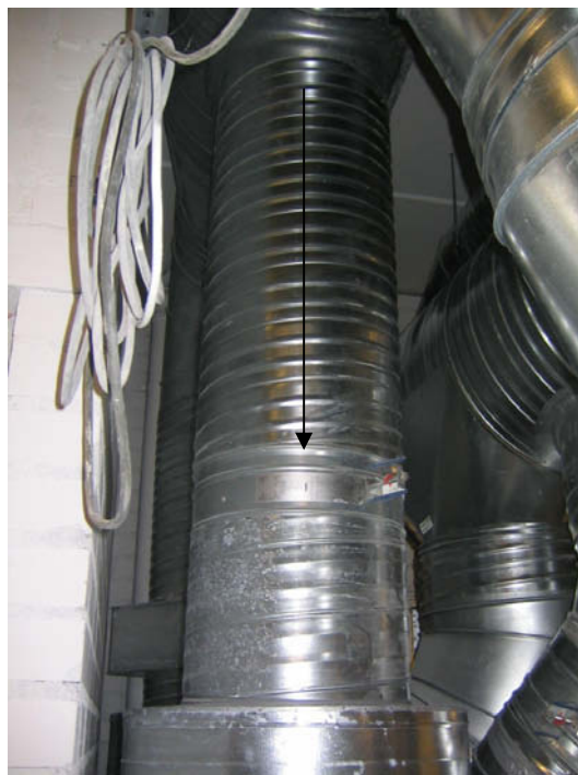
Kuva 6. Ilmavirran säätö- ja mittauslaitteen suojaetäisyys häiriöstä (90°-käyrä) on riittävä.
