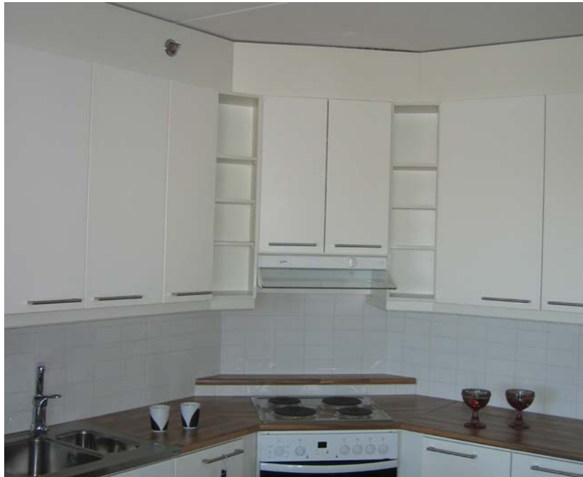
Kuva 16. Esimerkkikuva kohteen C sprinklauksen toteuttamisesta a) käytävässä ja b) asuintilojen osalta (sivusprinkleri).
