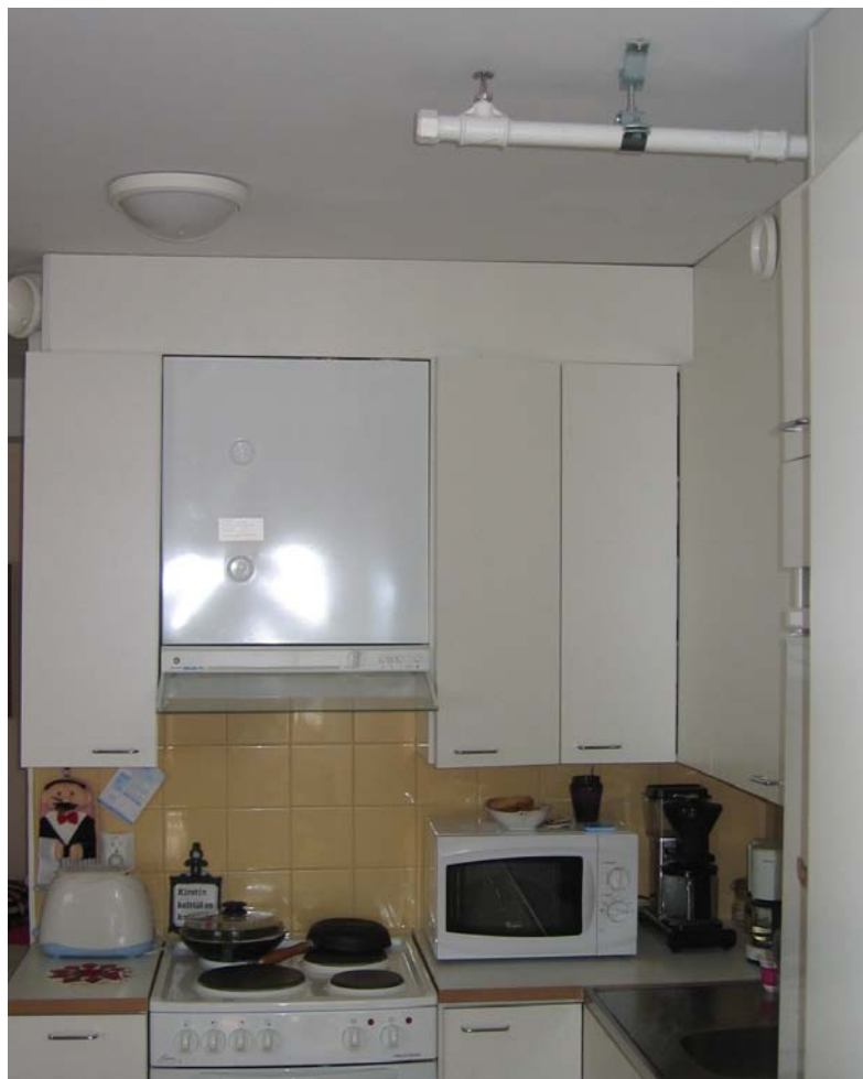
Kuva 18. Esimerkkikuva kohteen E sprinklauksen toteuttamisesta: a) sprinkleripääkeskus ja b) sprinkleriputkisto pinta-asennettuna.
