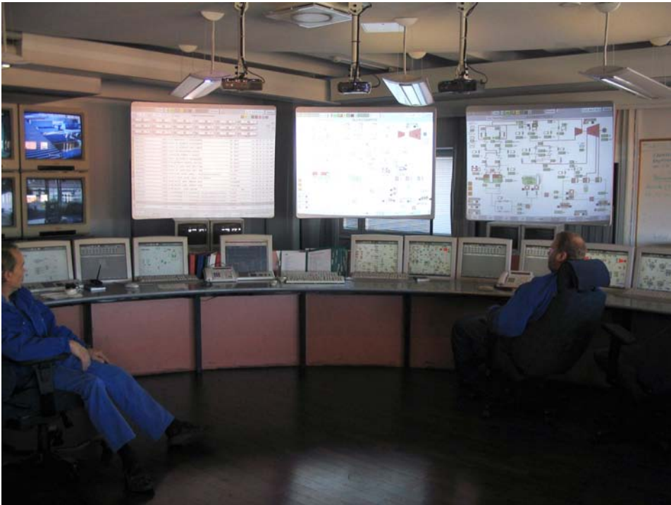
Kuva 1. Hanasaaren voimalaitos B:n valvomossa operaattoreilla on käytössään näyttöpäätteitä sekä kolme suurkuvanäyttöä.
