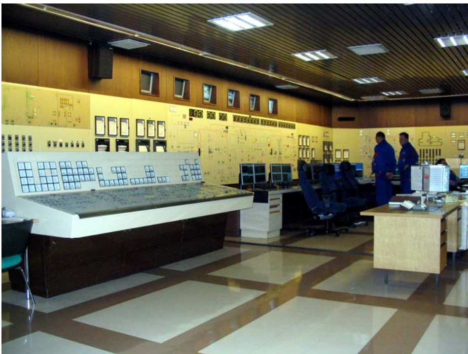
Kuva 3. Martinlaakson voimalaitoksen valvomossa on sekä digitaalisella että analogisella tekniikalla toteutettuja käyttöliittymiä. Valvomon analoginen pulpetti ja yksittäiset laiteohjaukset GP-taululta on purettu kesällä 2007 ja korvattu digitaalisella ohjauksella.
