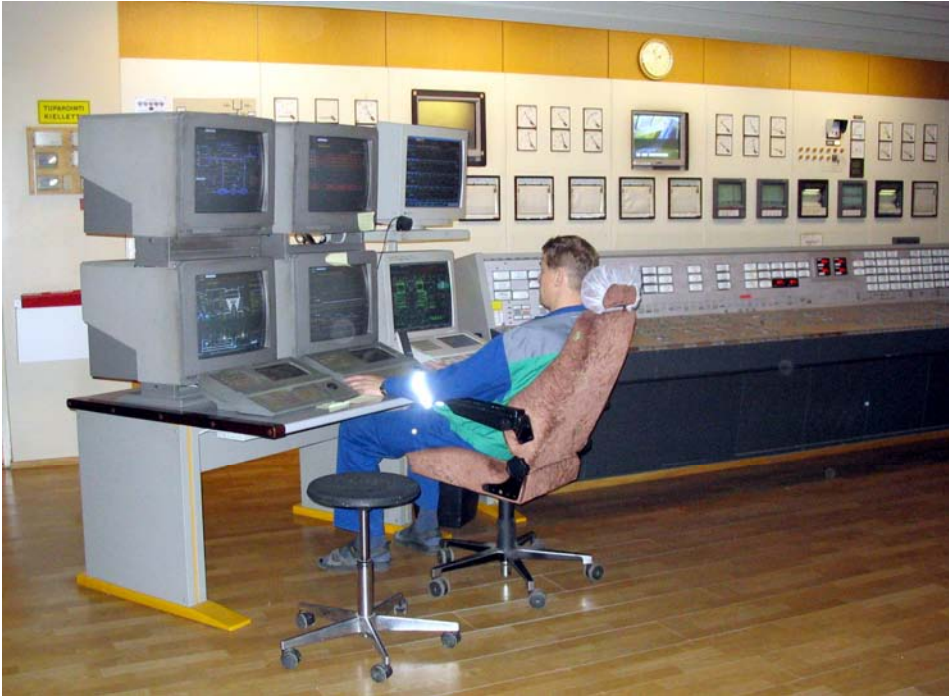
Kuva 4. Naantalın voimalaitoksen valvomoissa on sekä analogia- että digitaalitekniikalla toteutettuja käyttöliittymiä.
