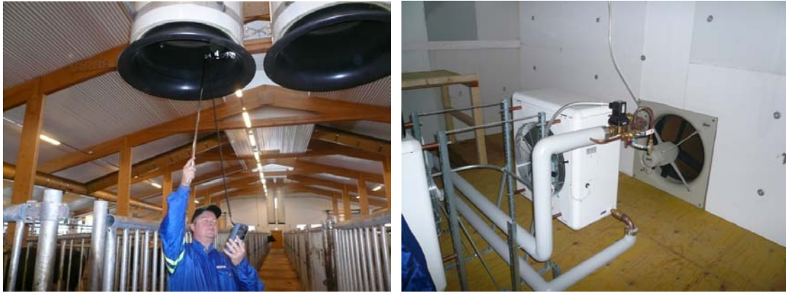
Kuva 56. a) Poistoilmavirrat mitattiin siipipyöranemometrillä. b) Katolla olevassa tuloilmavirran jakohuoneessa on kaksi tuloilmaukkoa ( d = 0,63 m), joissa on tuloilmapuhallin. Jakohuoneessa sijaitsevat myös tuloilman esilämmittimet.
