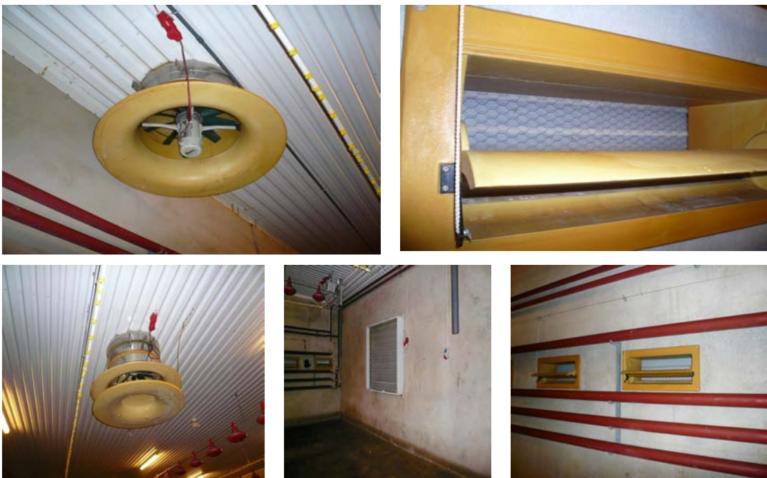
Kuva 96. Hallin poistoilmapuhaltimet ovat katossa. Ulkoilma johdetaan sisään ulkoilmaventtiilien kautta. Kierrätyspuhaltimilla tasoitetaan lämpötilaeroja ja lisäpuhaltimilla tehostetaan ilmanvaihtoa kesällä. Lisälämpö tuodaan putkistolla ulkoseinille.
