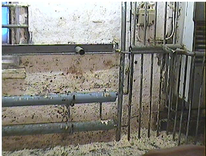
Kuva 47. Eläintilan lämpöpatterin pintalämpötila oli +38,5 °C.
