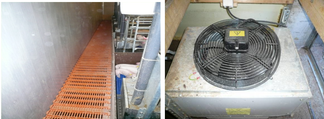
Kuva 74. a) Tuloilmaritilä, josta tuloilma virtaa osastoon. b) Tuloilmalämmitin (radiaattoripuhallin) alapohjassa, jota käytetään tuloilman esilämmittimenä. Puhallin imee ilman ylhäältäpäin ja jakaa sen alapuolelta joka suuntaan.
