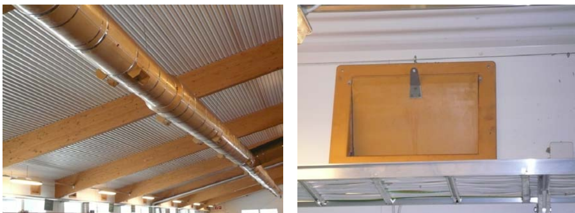
Kuva 57. a) Toinen tuloilmakanavista katossa. b) Sivuseinissä on 30 ulkoilman lämpötilan mukaan säätävää ulkoilmaventtiiliä.
