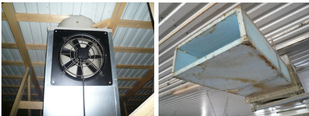
Kuva 67. a) Tuloilmapuhallin sijaitsee ullakolla poistoilmakanavan kyljessä. b) Tuloilma-aukkojen tarkoituksena on johtaa tuloilma sikalaan tasaisesti.
