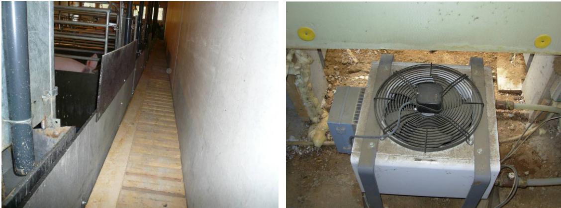
Kuva 86. a) Lautalattiaritilä, josta tuloilma virtaa osastoon vasemmalla olevan reunalevyn yli karsinaan. b) Alapohjassa on tuloilman lämmitin, jota käytetään lisälämmittimenä.
