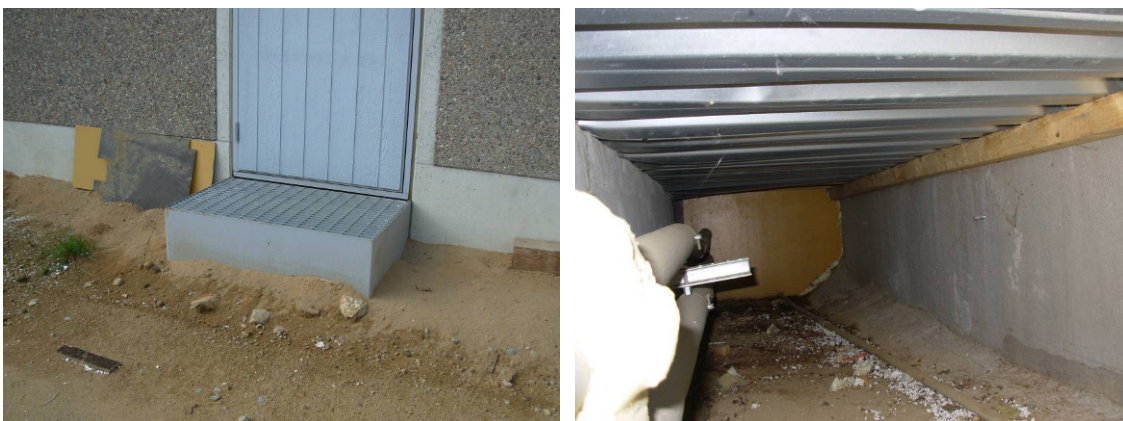
Kuva 85. a) Ulkoilma tulee sisään oven kohdalla olevan ritilän kautta. b) Alapohjan kanava, jota pitkin tuloilma siirtyy laualattiaritilälle seinustojen viereen.
