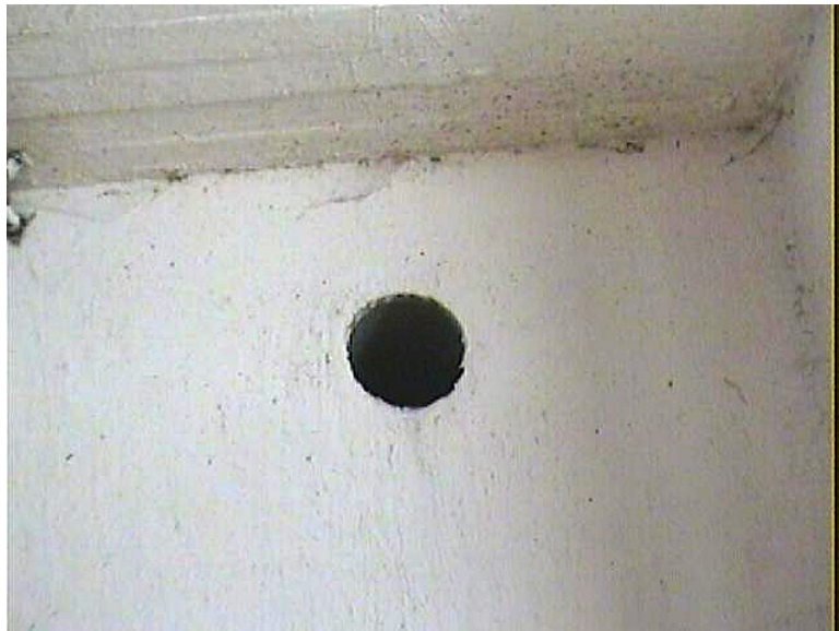
Kuva 46. Vasikkaosaston tuloilma-aukko, josta mitattiin tuloilman lämpötilaksi +15,1 °C. Seinärakenteen pintalämpötila oli vain +3,6 °C, mikä johtui yläpohjan heikosta lämmöneristyskyvystä.
