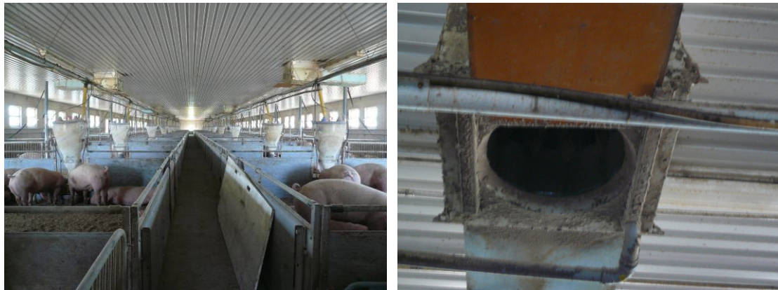
Kuva 66. a) Sikalan poistoilmakanavat ovat katossa, tulokanavat niiden sivuissa (siniset). b) Poistoilmakanava, puhallin kanavassa, kuristuslevy sekä kondenssikeräysputket.
