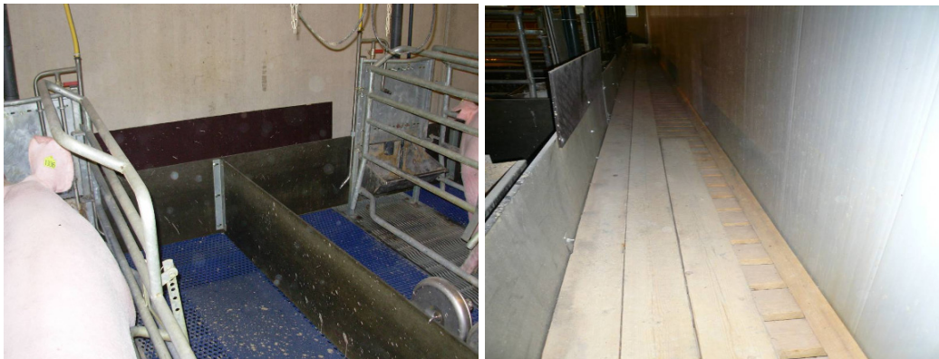
Kuva 93. a) Talvella vetomittaus tehtiin perustilanteessa, jossa korotetut reunalevyt olivat emakon toisella puolella porsaiden lämpölevyjen kohdalla vedon välttämiseksi. b) Tuloilman lautaritiläosaan tehtiin muutos kuristamalla tuloilmanvirtausta laudoilla koko matkalta. Päädyissä kuristus oli isompi kuin keskiosassa.
