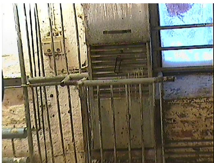
Kuva 48. Ilmastointikone oli ensimmäisenä mittauspäivänä jäässä, kun ulkolämpötila oli –20 °C. Seuraavana päivänä ulkolämpötilan kohottua –9 °C:een, ilmastointikone oli sulanut ja jälleen toiminnassa.
