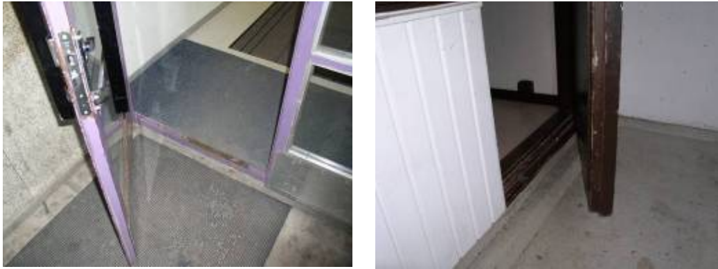
Kuva 23. Rakennusten remontoimattomien ulko-ovien ja parvekkeiden ovien tiivisteissä on puutteita, ja ovet ovat yleisesti huonossa kunnossa (kuvat Nikkanen 2009).
