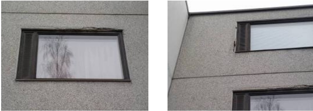
Kuva 18. Ulkoseinän rakenteet ovat kuluneet. Kuvassa betoniterästen ruostumisesta aiheutuneita lohkeamia (Kiinteistö Oy Riihenpuoli, kuvat Nikkanen 2009).
