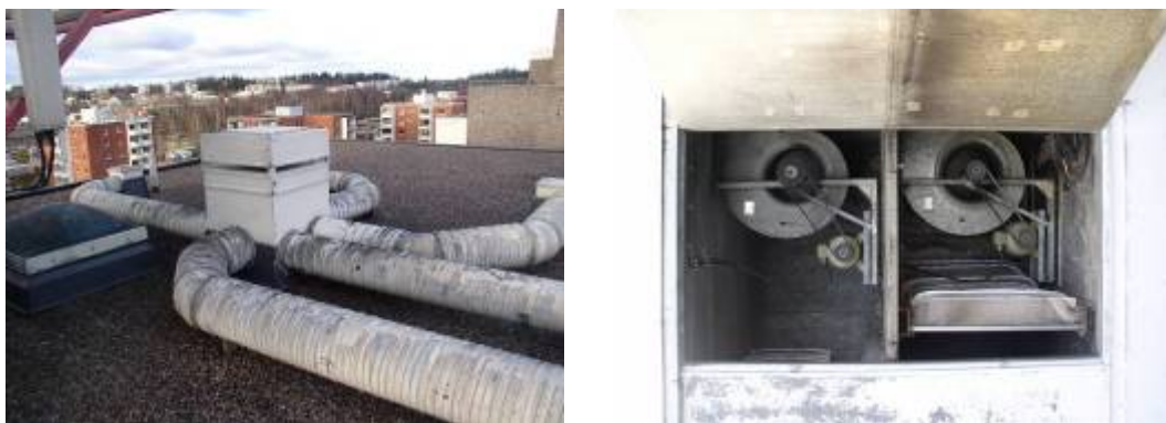
Kuva 20. Peltosaaren alueella on käytössä koneellinen poisto sekä koneellinen poisto- ja tuloilma. Kuvat taloista 2014-13 (vasen) ja 2017-6 (oikea) (kuvat Nikkanen 2009).
